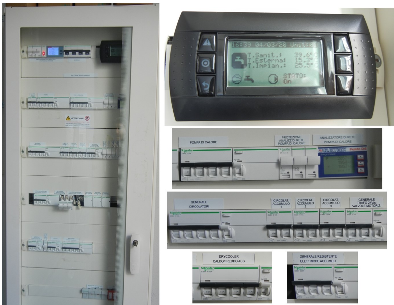
Figura 10: Quadro generale cabina 2 con particolare degli interruttori e componenti che lo costituiscono.
