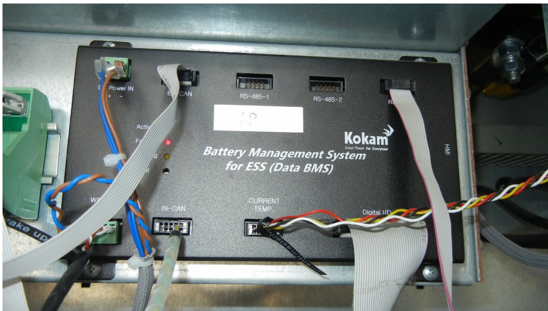
Figura 8: Apparato elettronico di controllo Battery Management System (BMS) delle batterie Kokam.
