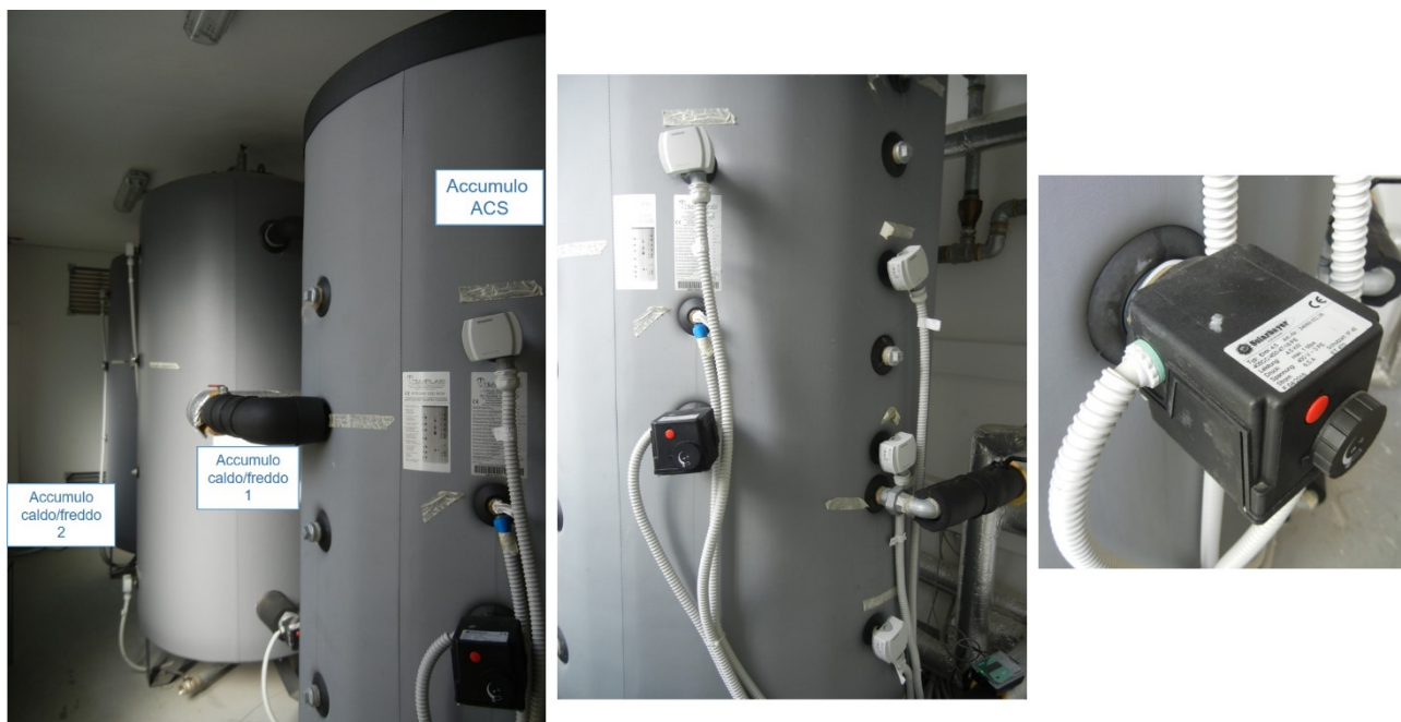
Figura 11: Sinistra: accumuli presenti in cabina 2 (due inerziali e uno ACS) – Centro: dettaglio installazione sensori temperatura e resistenza elettrica nell'accumulo ACS.– Destra: dettaglio resistenza elettrica dell'accumulo ACS.
