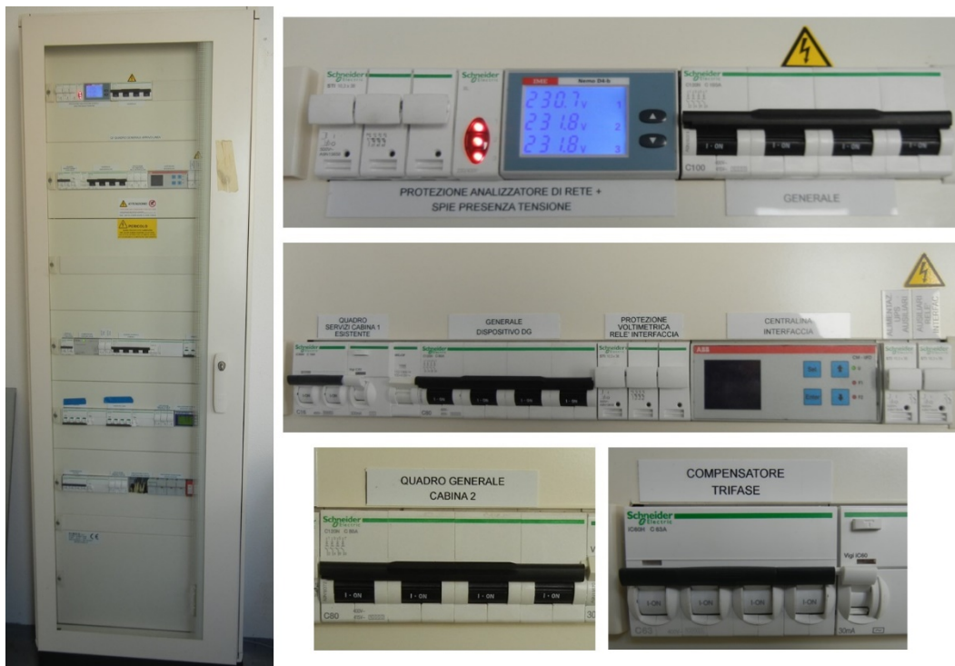
Figura 4: Quadro generale cabina 1 con particolare degli interruttori e componenti che lo costituiscono.
