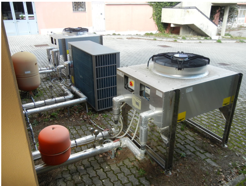
Figura 14: Dry cooler e pompa di calore installati all'esterno della cabina .
