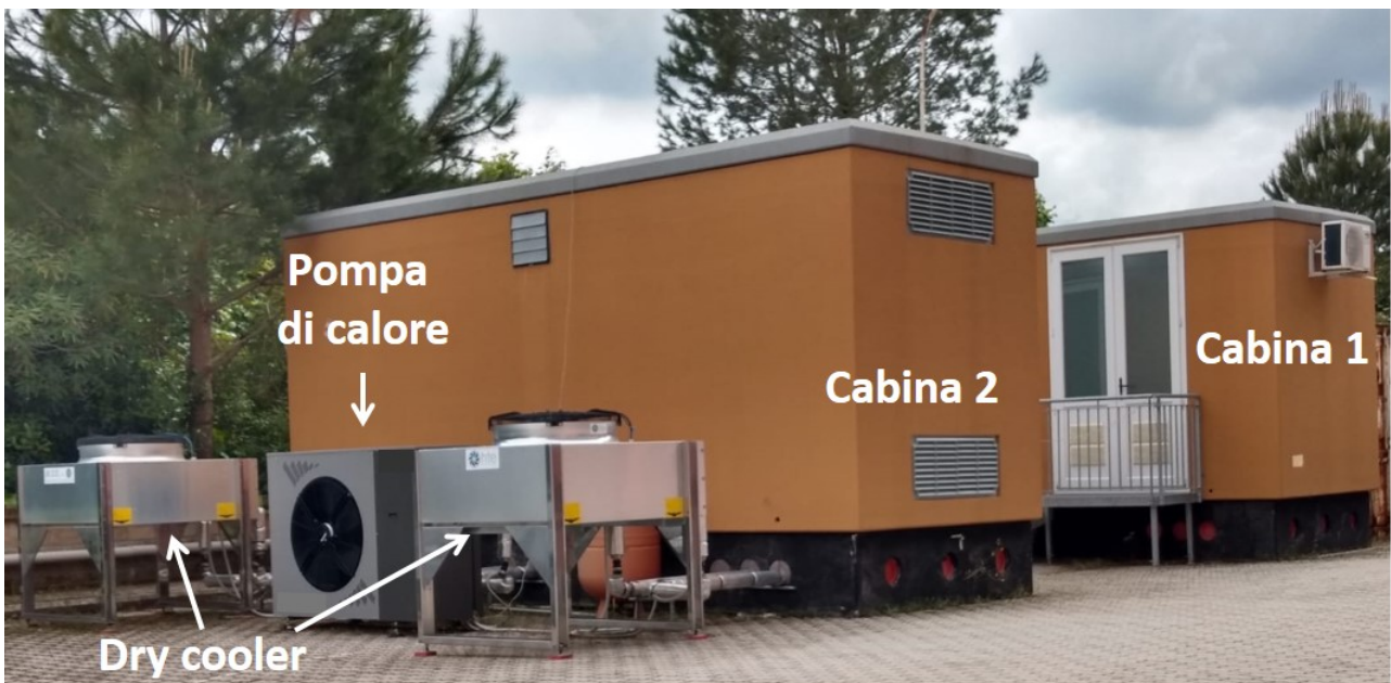
Figura 2: Impianto S.A.P.I.EN.T.E. installato nel C.R. Casaccia
