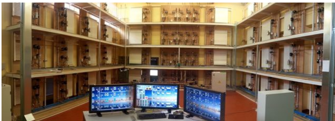
Figura 30 - Mockup sperimentale INRIM per la verifica dei sistemi indiretti di contabilizzazione
