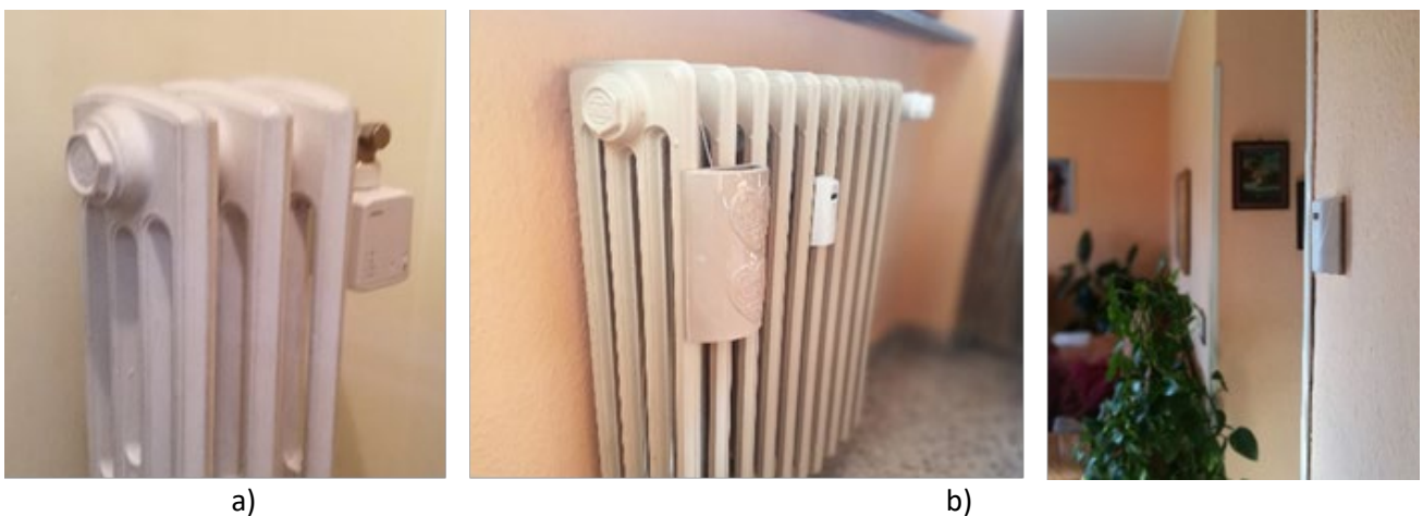
Figura 40 – a) Contatore tempi di inserzione con valvola termostatica elettronica (Edificio 18B); b) Valvole termostatiche e ripartitore di calore elettronico a due sensori e TLogger (Edificio 18C)
