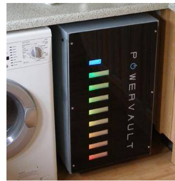
Fig. 2: PowerVault affiancato alla lavatrice.
