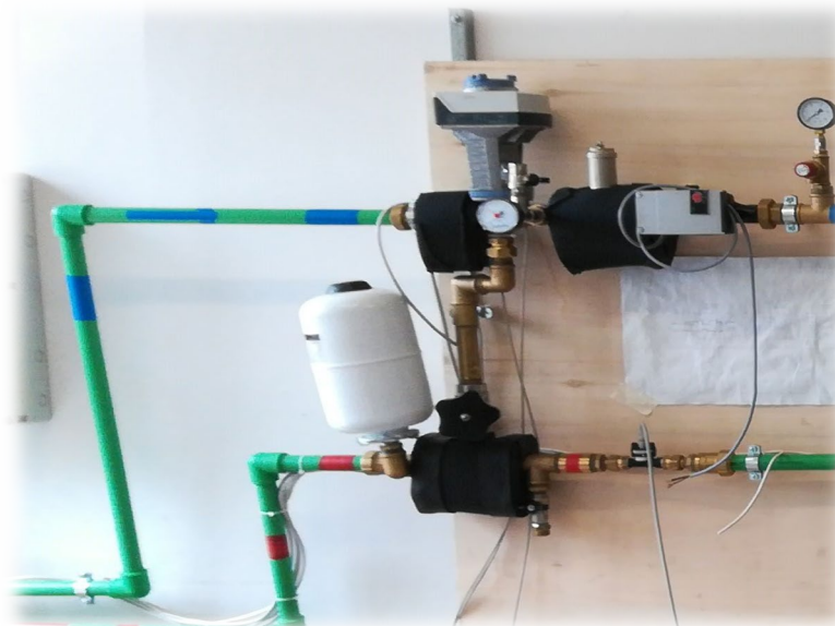
Figura 47. Gruppo idronico dell'emulatore di edificio.
