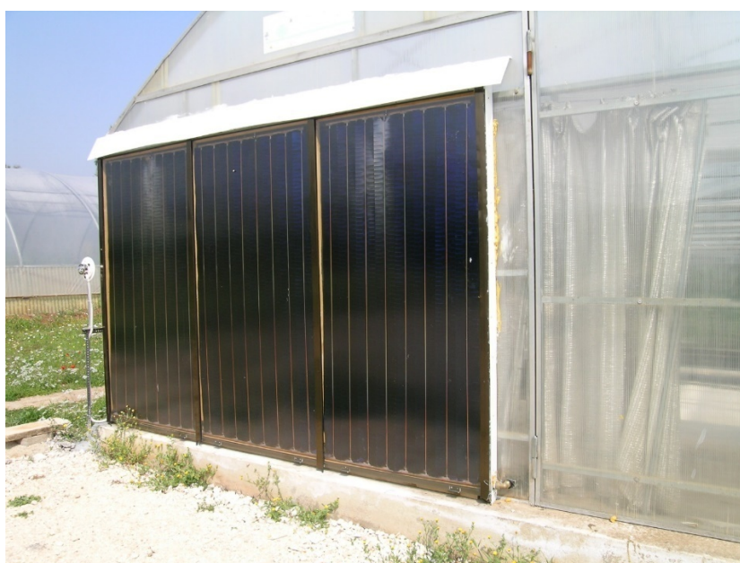
Figura 47. Collettori solari termici a servizio di una serra sperimentale collocati sulla testata a Sud.
