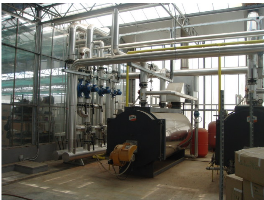
Figura 37. Caldaia in centrale termica a servizio di una serra.
