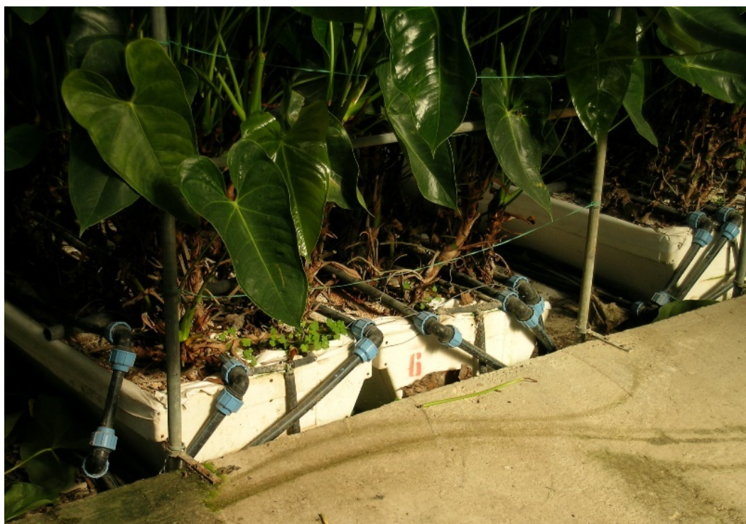
Figura 41. Sistema di riscaldamento a termosifone ad acqua calda con tubazioni in polietilene posizionate sul substrato di coltivazione.
