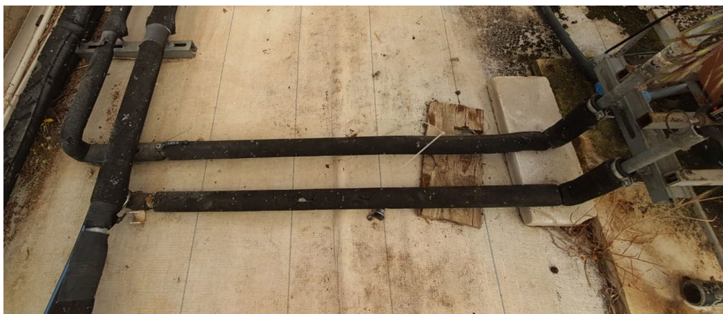
Figura 9: Tubazioni di congiunzione all'interno della serra
