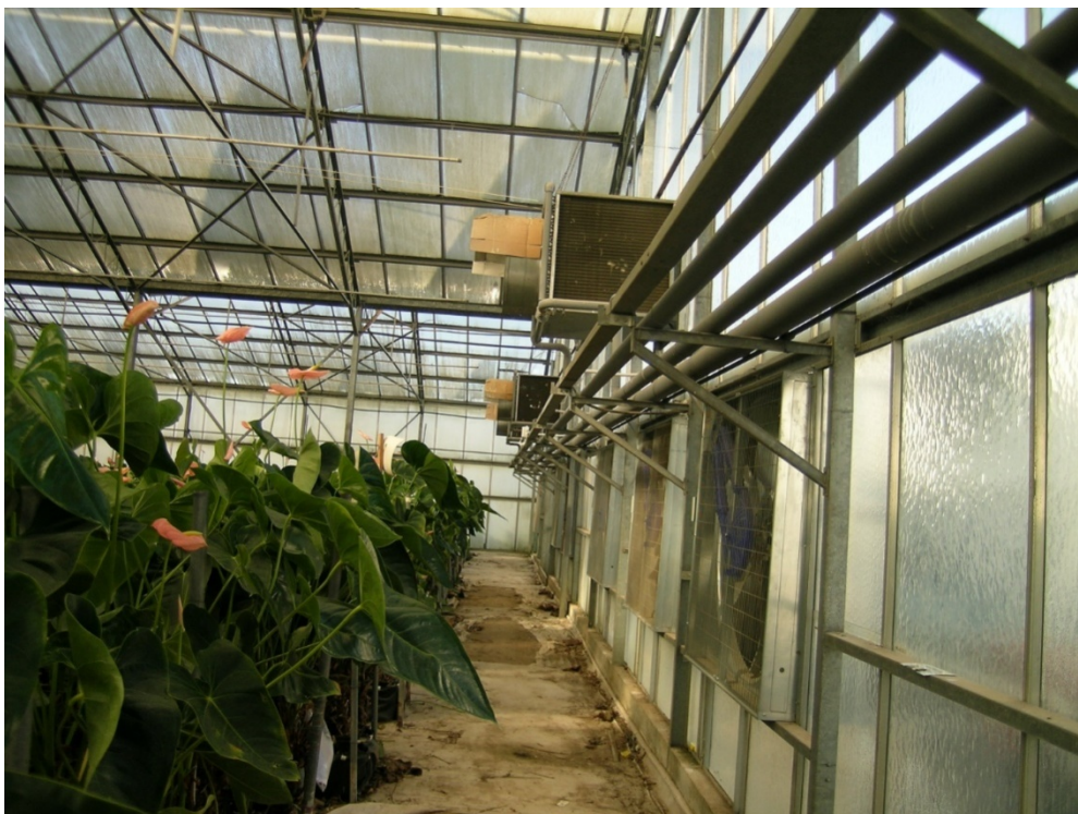
Figura 43. Aerotermi pensili installati all'altezza della linea di gronda, in corrispondenza di una testata di una serra per coltivazione floricola.
