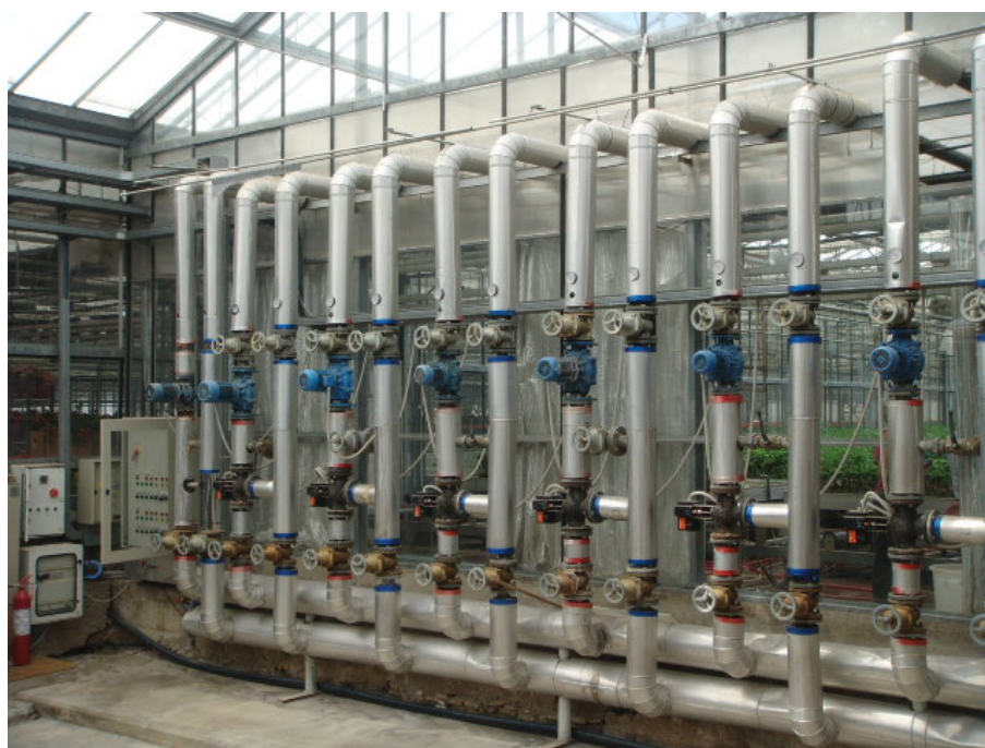
Figura 38. Collettori e diramazioni di mandata e di ritorno del fluido termovettore per un sistema di riscaldamento.
