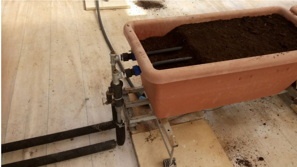
Figura 10. Sistema di distribuzione del freddo denominato "tubo interrato", realizzato con tubi posizionati all'interno del substrato di coltivazione.
