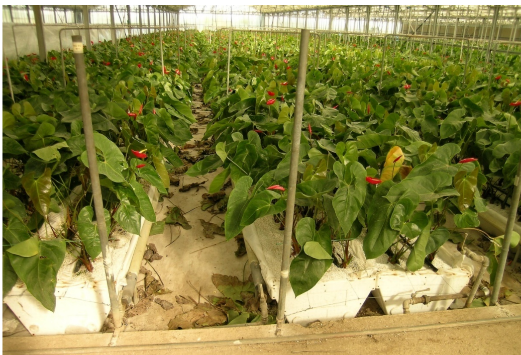
Figura 40. Sistema di riscaldamento a termosifone ad acqua calda con collocazione di tubazioni in acciaio a livello della base dei contenitori.
