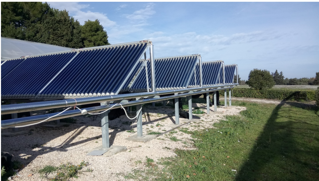
Figura 4. Il campo solare dell'impianto di solar cooling presso l'Università di Bari.
