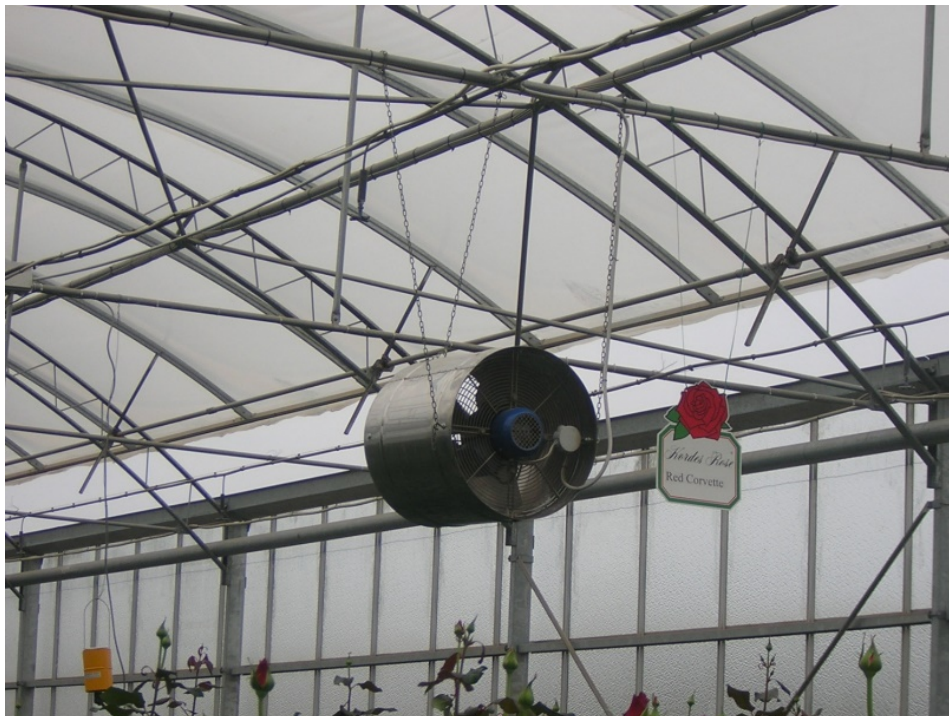
Figura 42. Miscelatore d'aria installato all'altezza della linea di gronda in una serra floricola.
