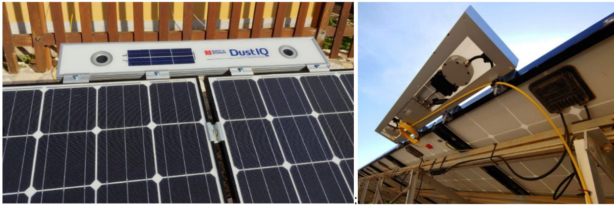
Figura 5.10. Installazione del sistema DustIQ su impianto FV presso l'Osservatorio Climatico ENEA di Lampedusa
