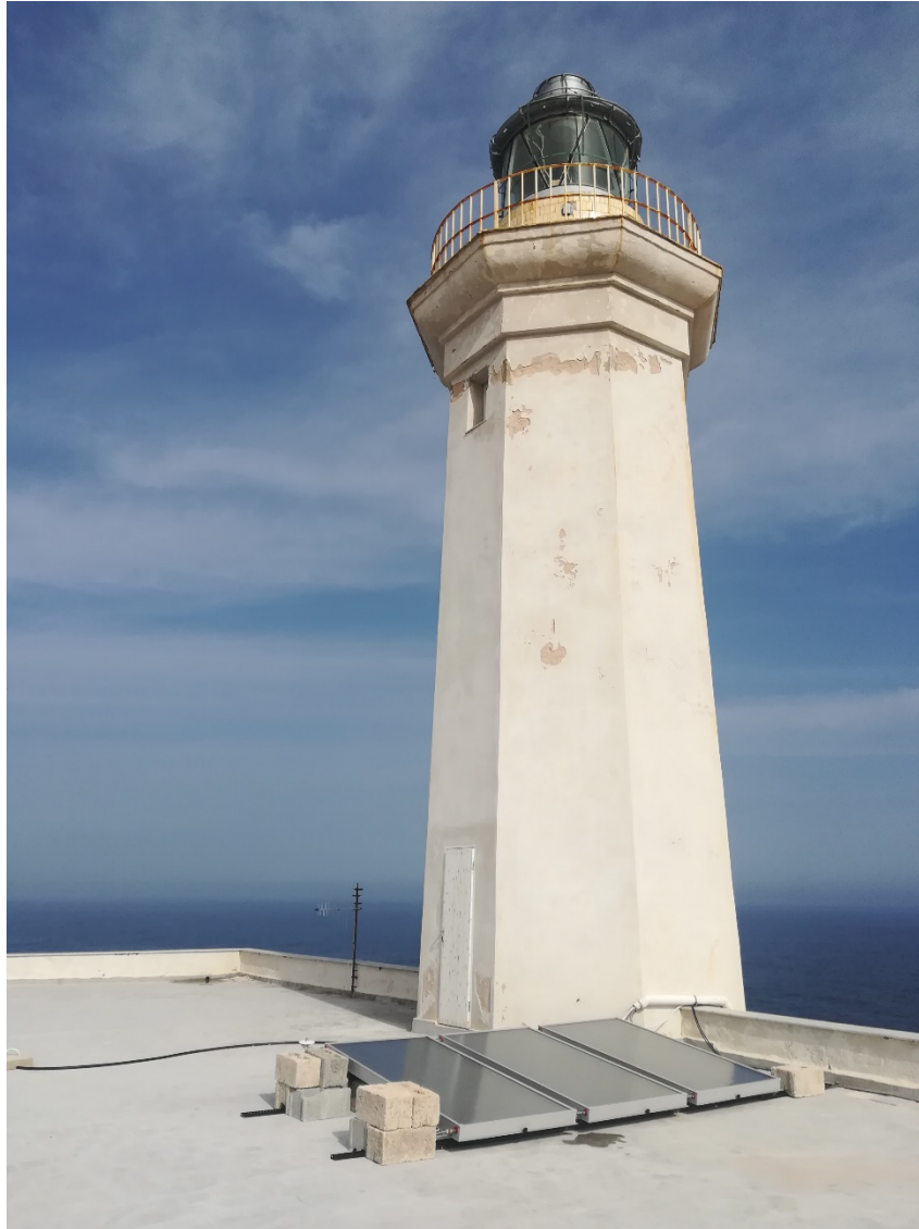
Figura 2.47. Collettori solari dopo il completamento dei lavori
