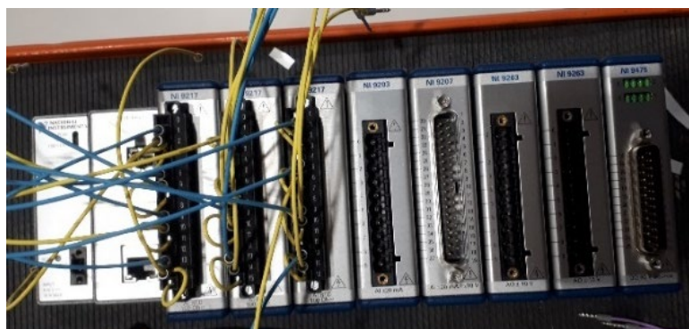
Figura 28. Acquisitore NI 9149 con moduli di acquisizione e controllo della sottostazione
