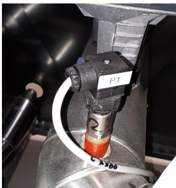
Figura 25. Sensore di pressione installato sulla sottostazione di scambio termico
