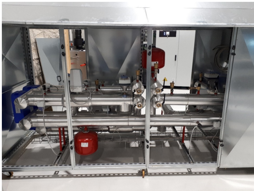
Figura 21. Vista interna della sottostazione
