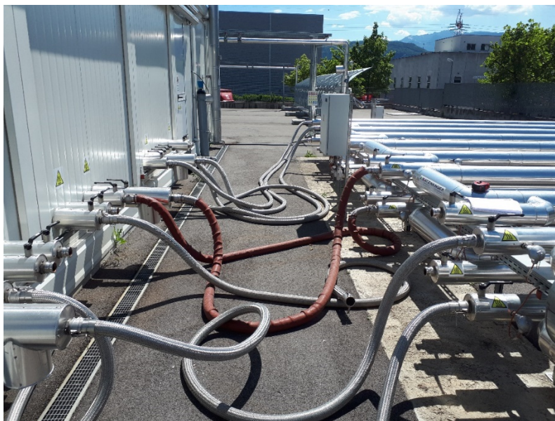
Figura 22. Luogo d'installazione della sottostazione presso la test facility di Eurac Research
