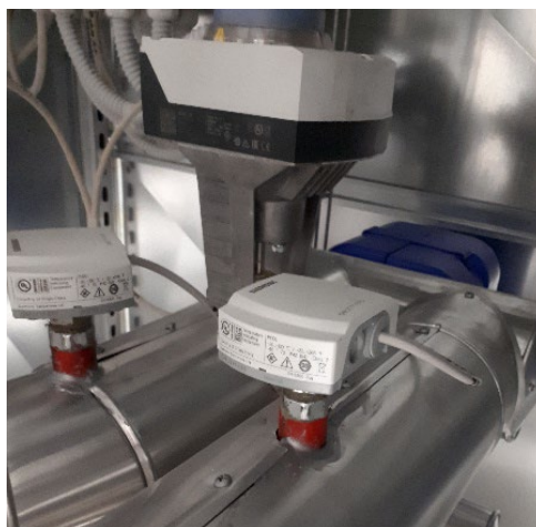
Figura 23. Sensore di temperatura installato sulla sottostazione
