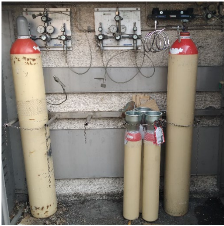
Bombole di alimentazione per la linea ad idrogeno
