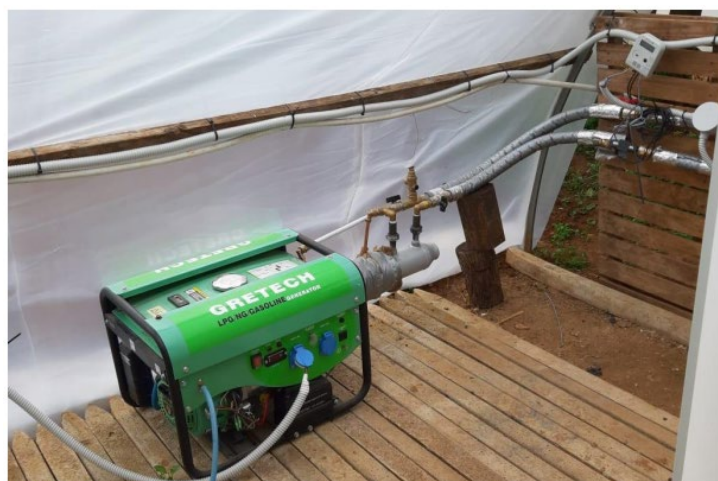
Figura 4-9: Motore a combustione interna installato presso il laboratorio sperimentale per provare il sistema di micro cogenerazione da biogas
