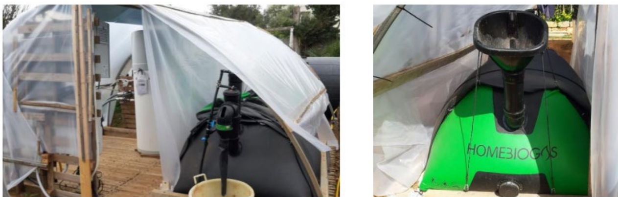
Figura 4-7: Installazione del biodigestore presso il sito di prova – sede startup “I nuovi mille” – Marsala (TP)
