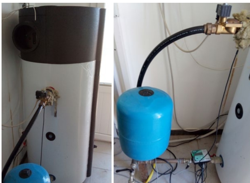
Figura 2-3: Foto pompa di calore per ACS installata presso il laboratorio di Lampedusa – dettaglio valvola comandata da PLC su circuito di mandata - misuratore di portata ultrasuoni nel circuito di ritorno e sensore di temperatura PT 500 posizionato a monte della valvola
