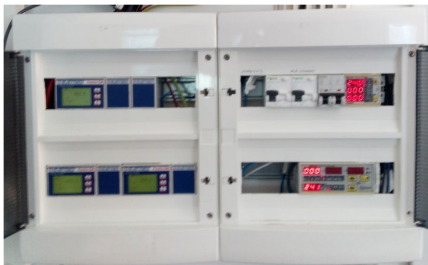
Figura 2-12: Quadro di misura e trasmissione dati in modbus: quadro di destra misura la CC – quadro di sinistra misura lato CA
