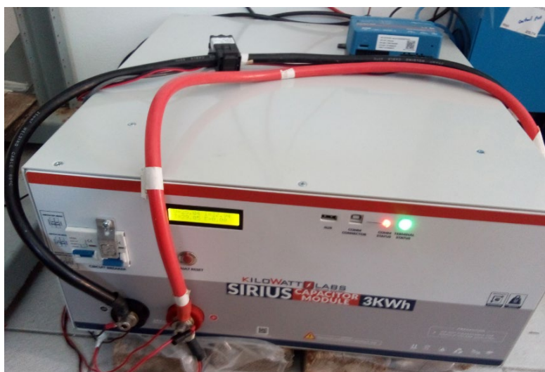
Figura 2-16: Supercondensatori da 3 kWh – 24 V connessi al nuovo convertitore
