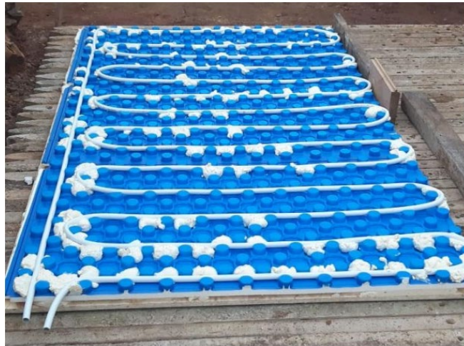
Figura 4-8: Piastra termica per fornire il calore di scarto al biodigestore per mantenere il digestato ad una temperatura maggiore di 30°C
