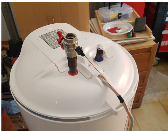
Figura 2-32: Parte inferiore dello scaldabagno con le connessioni elettriche verso il relè e la scheda Arduino
