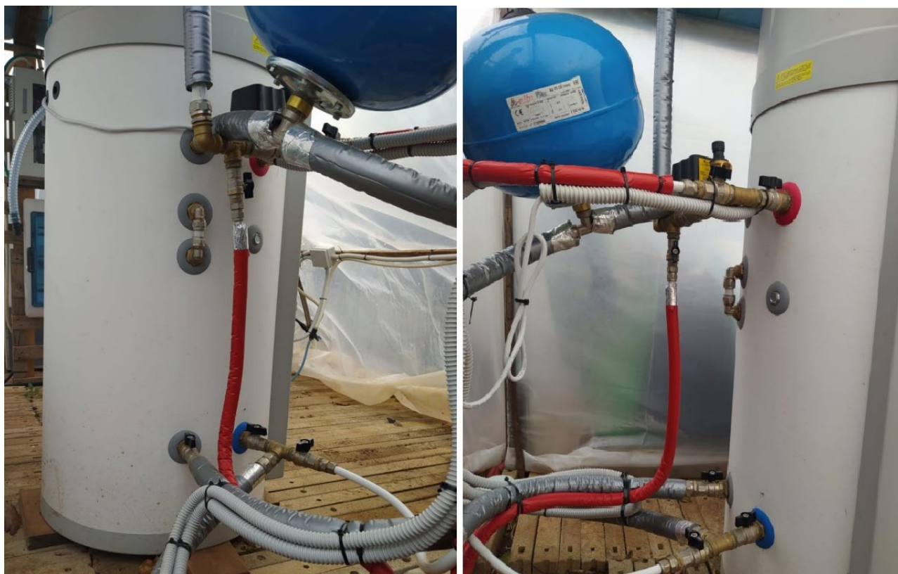
Figura 4-10: Pompa di calore installato presso il laboratorio sperimentale per provare il sistema di micro cogenerazione da biogas. Particolare connessione idraulica esterna per collegare in serie lo scambiatore alto e lo scambiatore basso dell'accumulo termico
