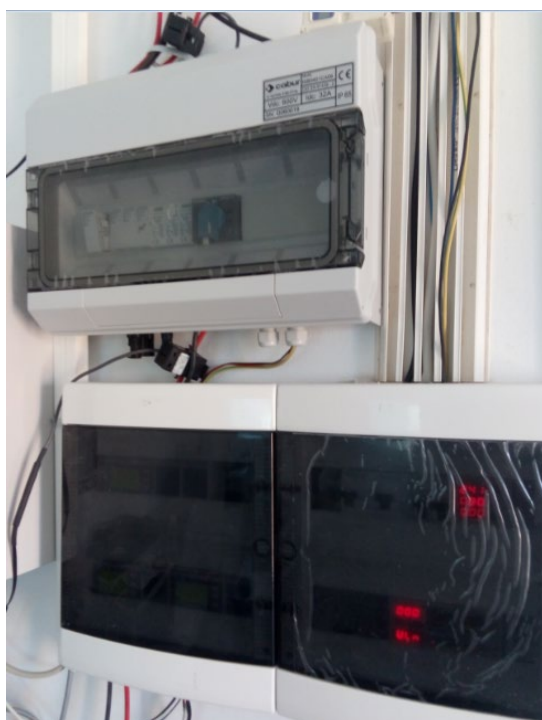
Figura 2-13. Quadri di sezionamento e misura: vista generale
