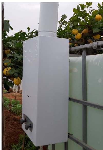
Figura 4-13: Caldaia alimentata a biogas installata presso il laboratorio sperimentale
