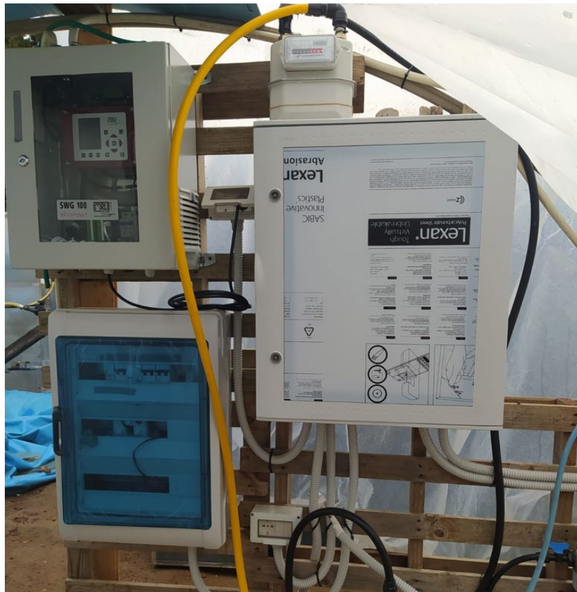
Figura 4-17: Laboratorio sperimentale sezione misura biogas e quadri elettrici. Analizzatore di biogas (in alto a sinistra), contatore volumetrico biogas (in alto a destra), quadro elettrico alimentazione pompa di calore in isola da micro cogeneratore (in basso a sinistra), quadro elettrico alimentazione da rete strumenti (in alto a destra)
