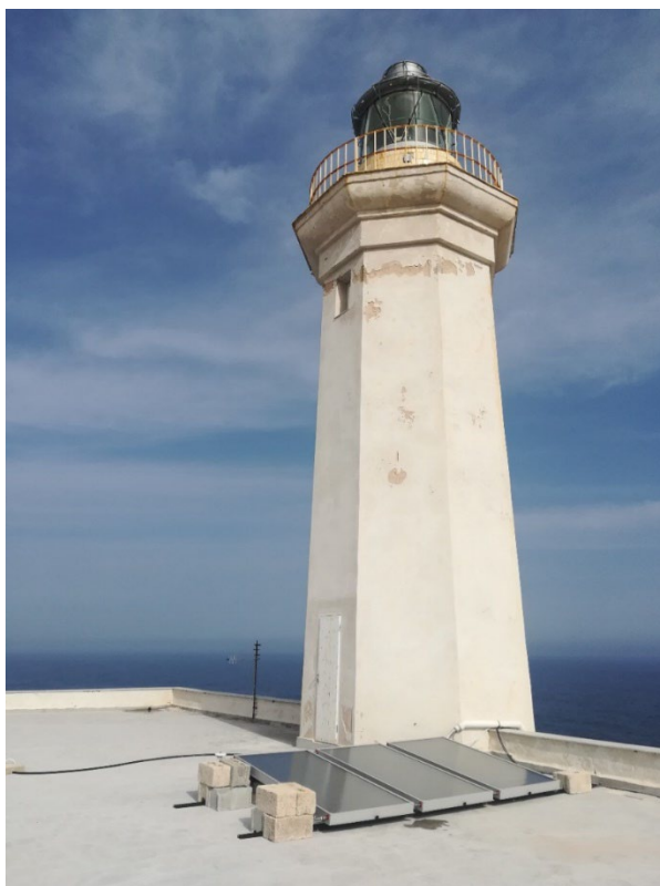
Figura 3-10: Collettori solari dopo il completamento dei lavori
