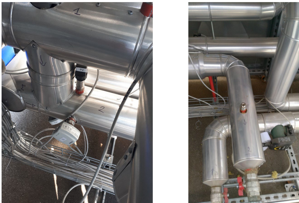
Figura 5.145. Posizione sensore di temperatura T2 prima (sinistra) e dopo (destra) lo spostamento
