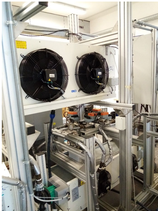
Figura 3. Scambiatori di calore utilizzati per simulare i carichi di refrigerazione.
