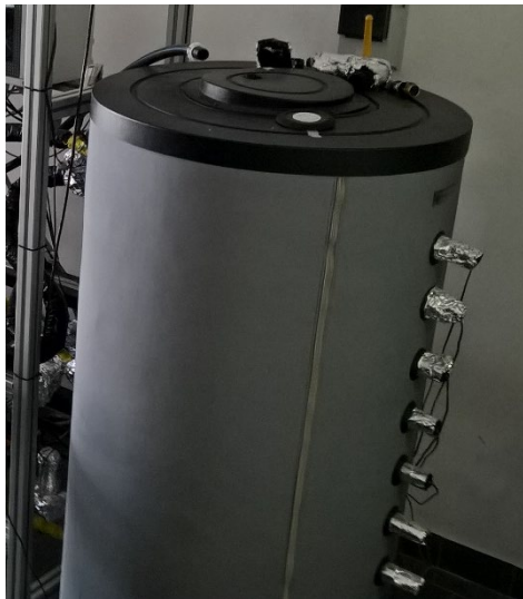
Figura 5. Serbatoio da 400 litri con 120 bottiglie di PCM.
