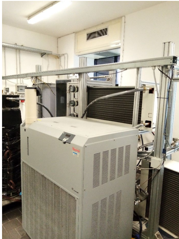
Figura 2. Impianto prova accumulo freddo presso il CR Enea Portici.
