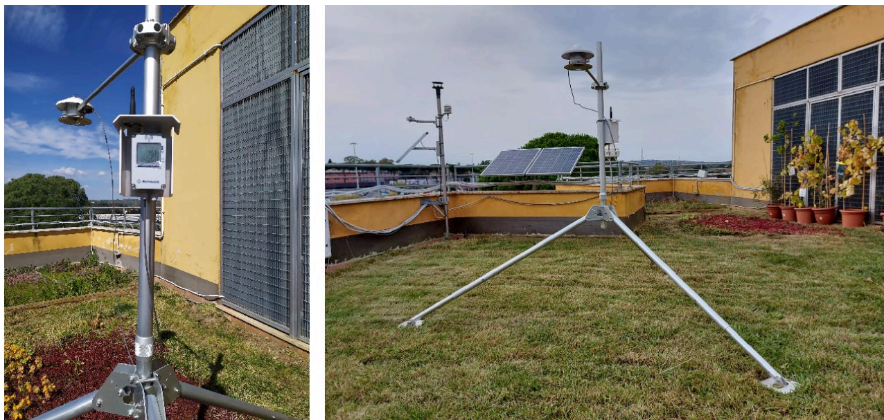
Figura 29. Albedometro LPPYRA11 della DELTAOHM sul tetto verde ENEA. In primo piano nella fotografia a sinistra è visibile la centralina wireless.
