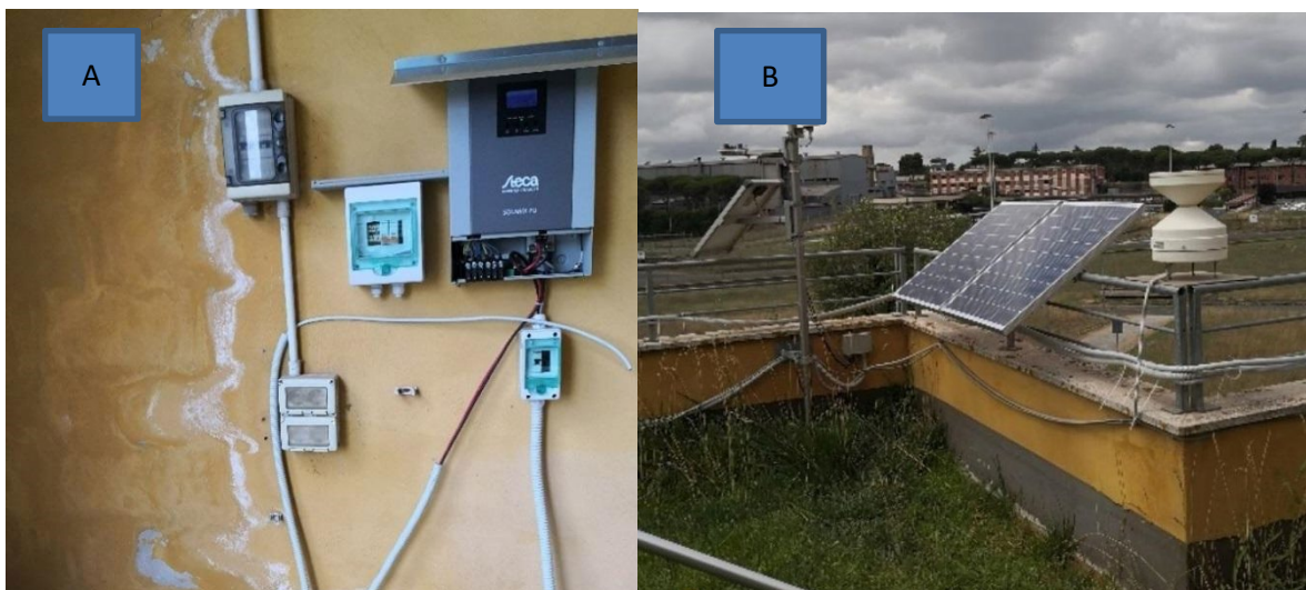
Figura 64. A -Inverter e sistema di collegamento posizionati nella stanza magazzino adiacente il tetto verde; B -pannelli solari posizionati sul tetto verde dell'edificio F92
