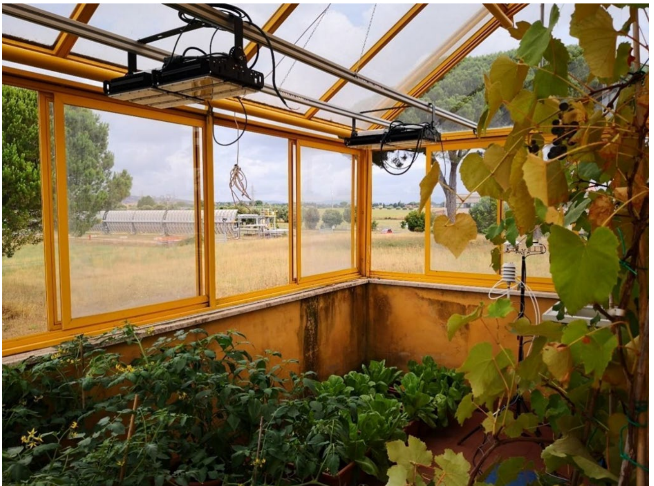
Figura 63. Serra bioclimatica con le lampade a LED installate.
