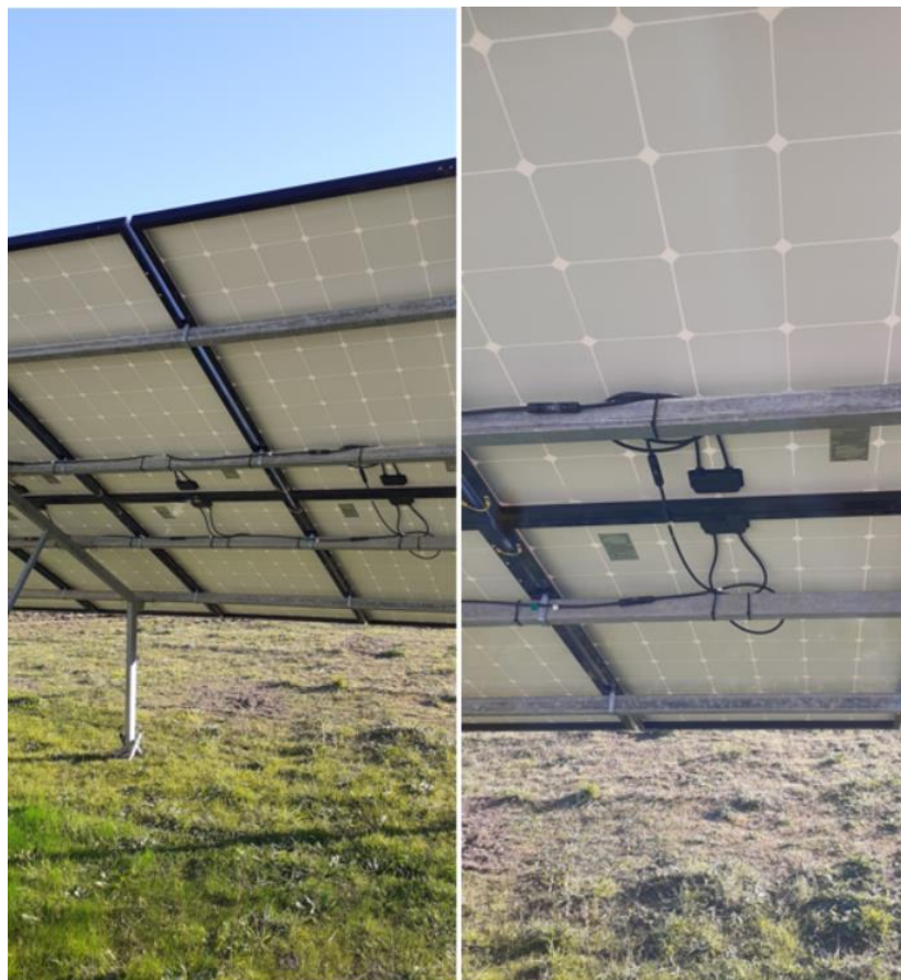
Figura 27: Foto dettaglio connessioni elettrica in serie dei moduli fotovoltaici.
