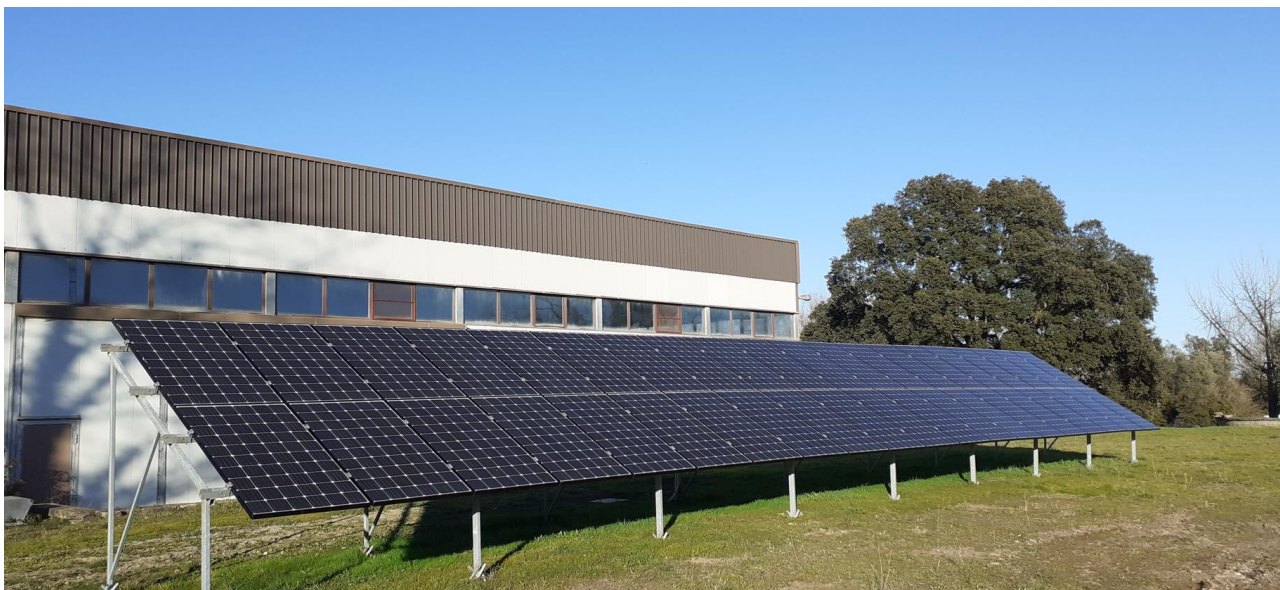
Figura 26: Visuale dell'impianto fotovoltaico a valle dell'installazione dei pannelli.
