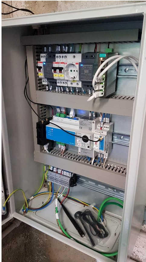
Figura 221: Quadro di comunicazione con dispositivo ICT installato nel locale tecnico del condominio 3.
