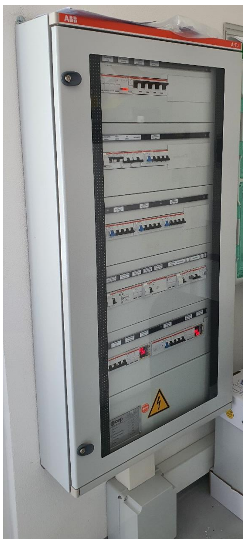
Figura 62: Quadro elettrico QE_3 installato all'interno della cabina 3.
