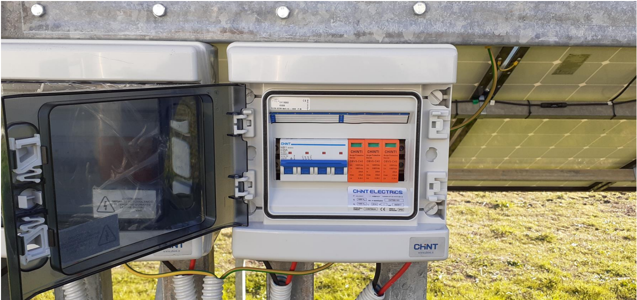
Figura 29: Foto di dettaglio del quadro di sezionamento stringa.
