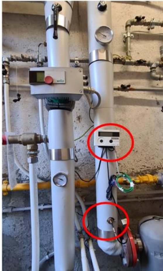
Figura 222: Installazione contatore energia termica (UHF 40-10) installato a piè di stabile del condominio 3 e relative sonde di temperatura sulla condotta di mandata e ritorno.
