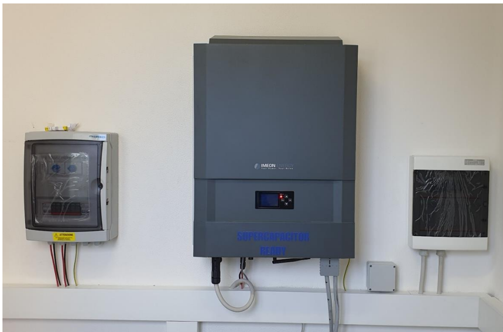
Figura 64: Inverter ibrido installato nella nuova cabina. A sinistra il quadro di sezionamento stringhe e a destra il quadro contenente lo smart meter dell’inverter ibrido.
