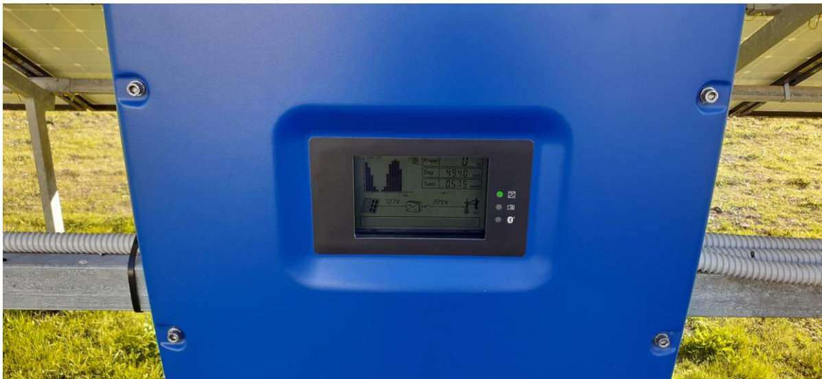
Figura 30: Foto di dettaglio del inverter trifase e delle informazioni fornite dal display.
