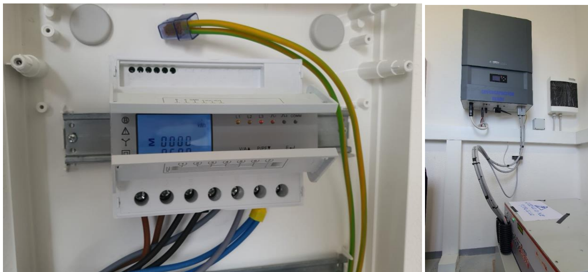
Figura 65: Foto di dettaglio del cablaggio ad inserzione diretta dello smart meter connesso all’inverter ibrido e foto del collegamento dell’inverter ibrido con un banco di supercondensatori.
