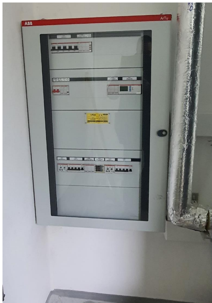
Figura 32: Quadro QE_2.2 installato in Cabina 2: Alimentazione inverter campo FV 11,4 kWp – alimentazione inverter ibrido termo-fotovoltaico (PVT) 6 kWp – con Dispositivo di interfaccia (DDI) e Sistema di protezione di interfaccia (SPI).
