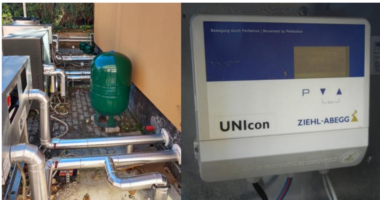
Figura 4: Sinistra: connessione idraulica dei dry cooler, della pompa di calore e dei vasi di espansione installati all'esterno della cabina. Destra: terminale di controllo del dry cooler per impostare i parametri di regolazione della velocità delle ventole via Modbus.
