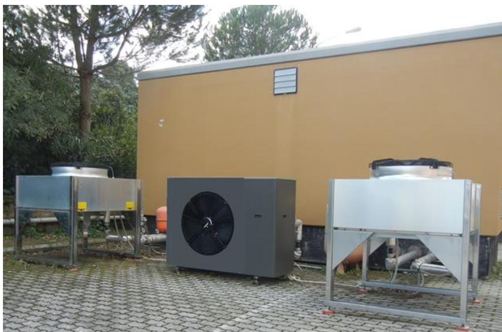
Figura 2: Alcuni dei componenti del sistema S.A.P.I.EN.T.E. installato nel C.R. Casaccia.
