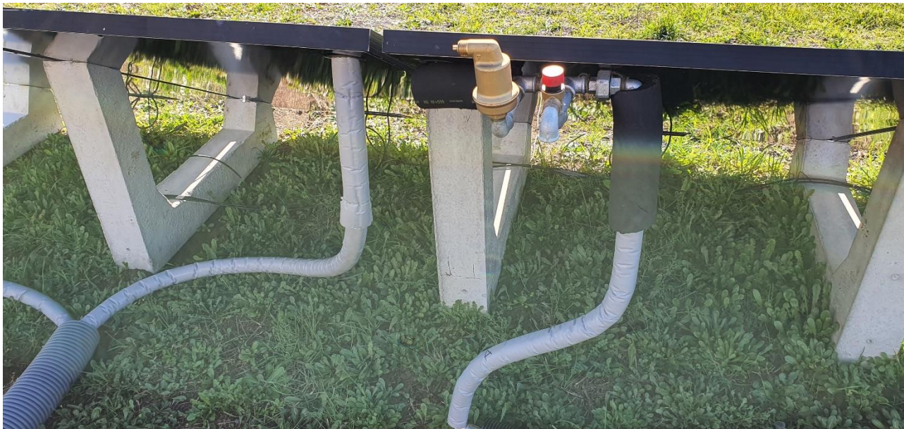
Figura 72: Dettaglio del disaeratore in ottone installato sul circuito di ritorno.
