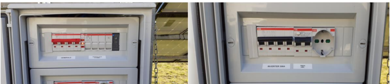
Figura 31: Dettagli sezione superiore e inferiore quadro corrente alternata del campo fotovoltaico QE_FV.
