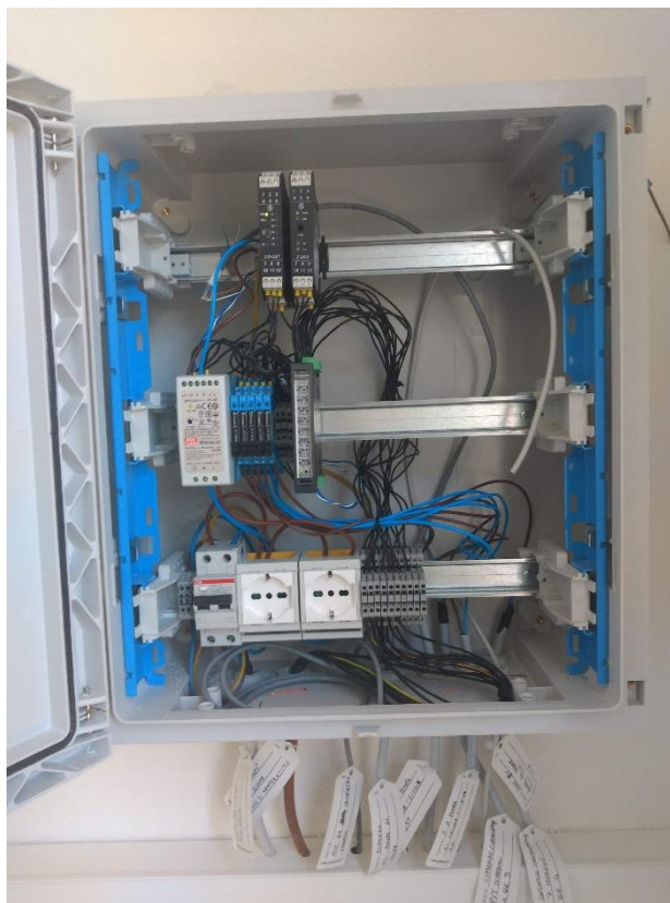
Figura 66: Quadro elettrico contenente il modulo PLC installato in Cabina 3
