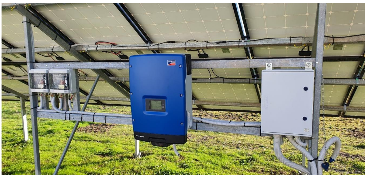
Figura 28: Da sinistra verso destra: quadri di sezionamento stringhe, inverter Sunny TriPower, quadro di campo fotovoltaico (QE_FV).
