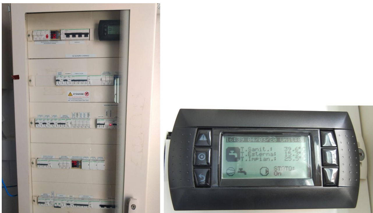
Figura 5: Sinistra: quadro elettrico generale della sezione termica dell'impianto. Destra: terminale di controllo della pompa di calore.
