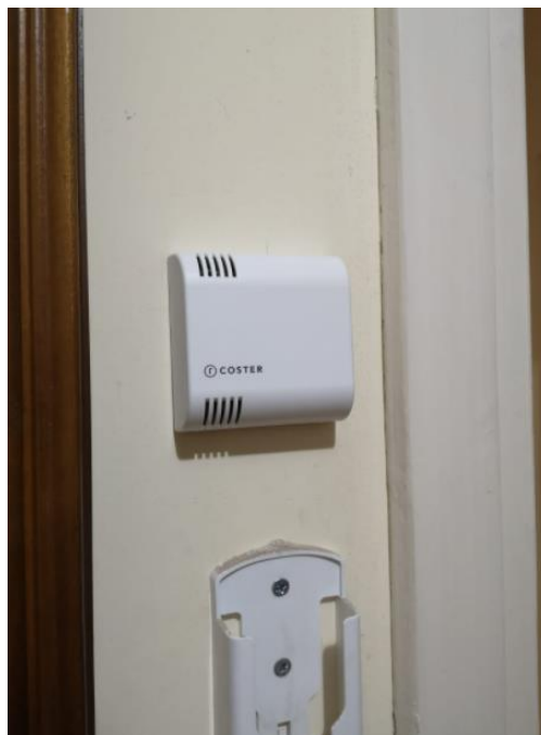
Figura 223: Installazione dei sensori di temperatura e umidità THP868 - condominio 2.
