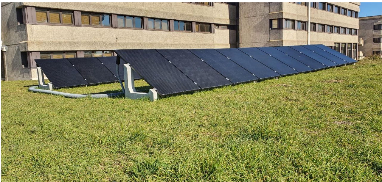
Figura 73: Vista frontale dell'impianto PVT ultimato.
