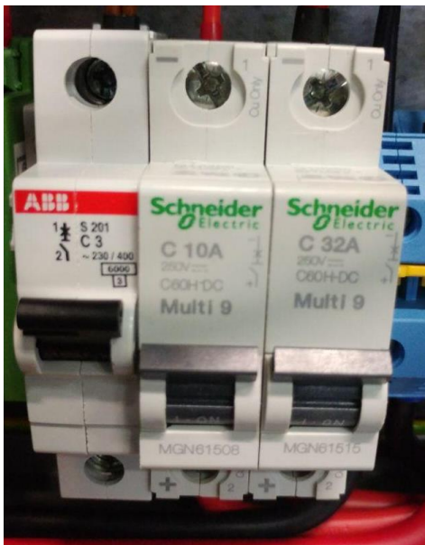
Figura 12 - Interruttori magnetotermici installati nel quadro elettrico
