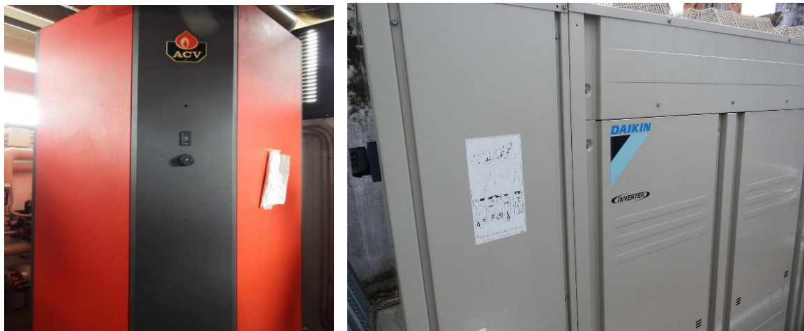
Figura 3-5 A sinistra foto del serbatoio tank in tank ACV, a destra foto di una delle due pompe di calore Daikin posizionate sulla torretta aperta
