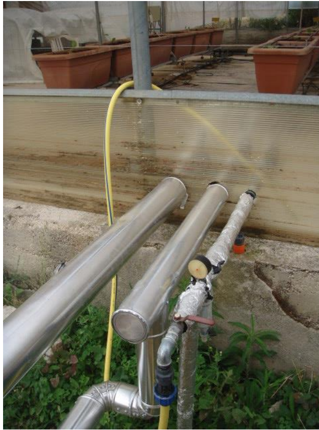
Figura 19. Tubazioni principali che trasportano all'interno della serra l'acqua fredda/calda.
