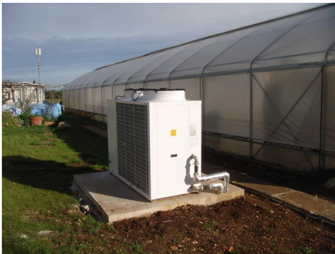
Figura 3. Pompa di calore aria-acqua presso l'Università di Bari.
