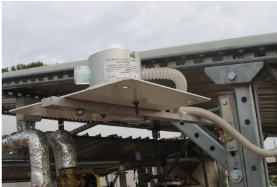
Figura 29. Sensore: piranometro per la misura della radiazione solare.
