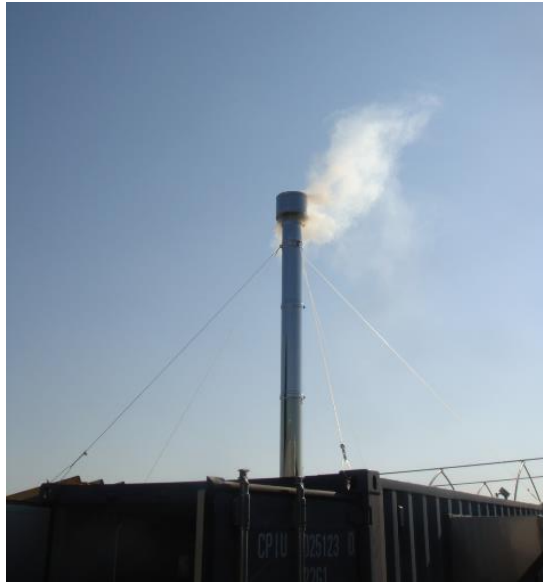
Figura 7. Canna fumaria della caldaia a biomassa CS30 presso l'Università di Bari.
