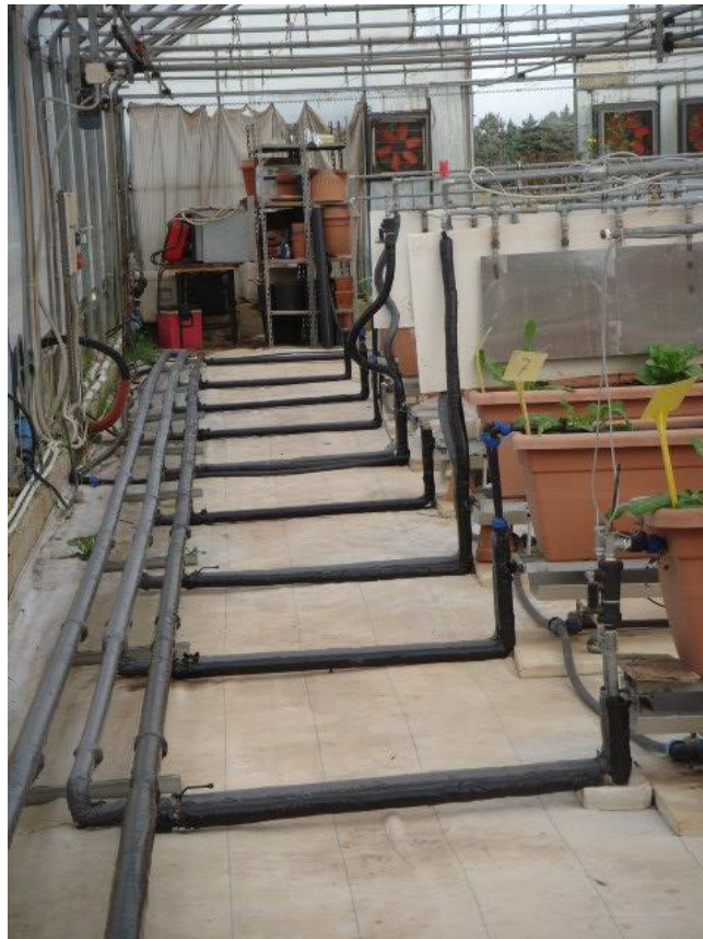
Figura 20. Tubazioni di mandata e ritorno all'interno della serra.
