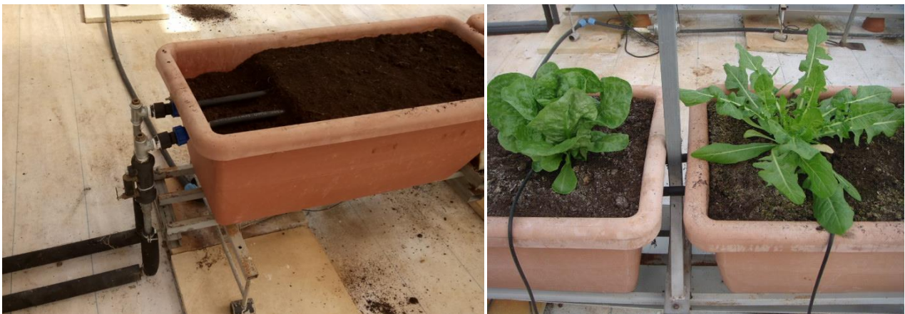
Figura 22. Sistema di distribuzione del freddo/caldo denominato "tubo interrato", realizzato con tubi posizionati all'interno del substrato di coltivazione.
