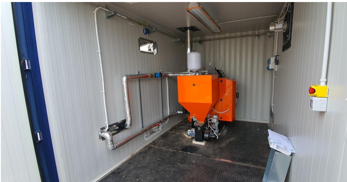
Figura 2. Caldaia a biomassa presso l'Università di Bari.
