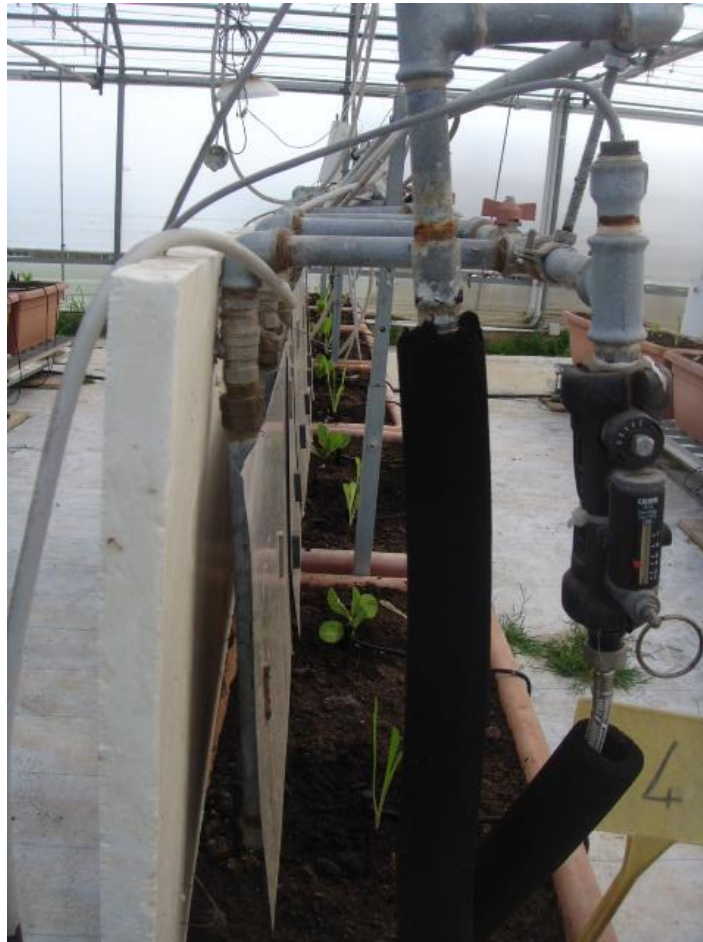
Figura 25. Particolare del sistema di distribuzione del freddo/caldo denominato “piastra e tubo”.
