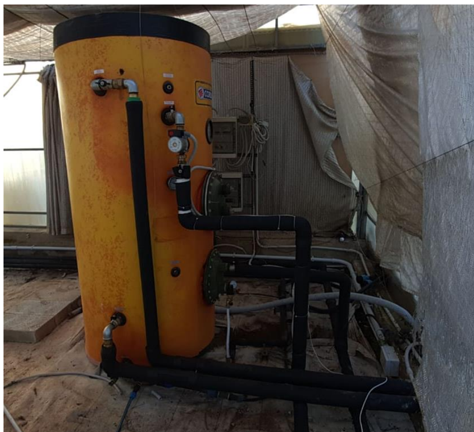
Figura 4. Serbatoio ausiliario da 1000 l all'interno della serra alimentato dall'impianto solare e dalla pompa di calore aria-acqua presso l'Università di Bari.
