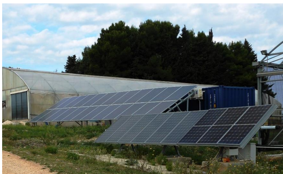
Figura 45. Impianto fotovoltaico presso l'Università di Bari.
