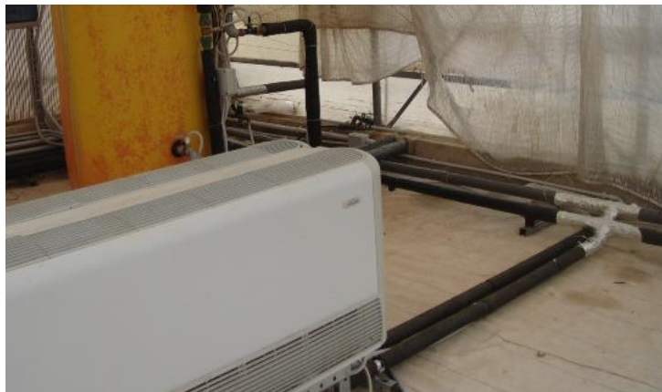
Figura 11. Ventilconvettori all'interno della serra.
