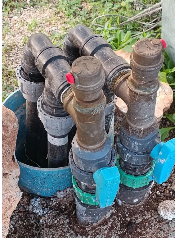
Figura 2. Tubi della sonda geotermica in ingresso nel terreno.
