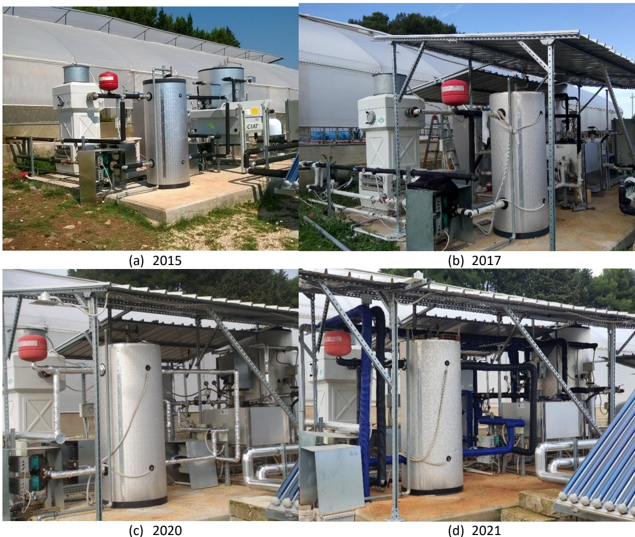
Figura 18. Coibentazione dei tubi di distribuzione nel corso degli anni.
