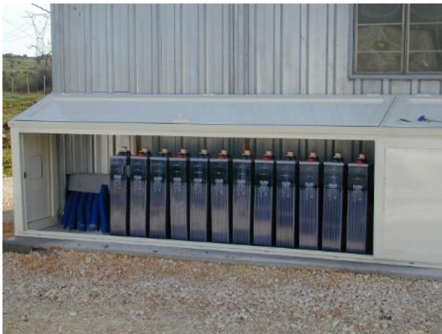
Figura 46. Sistema di batterie di accumulo presso l'Università di Bari.
