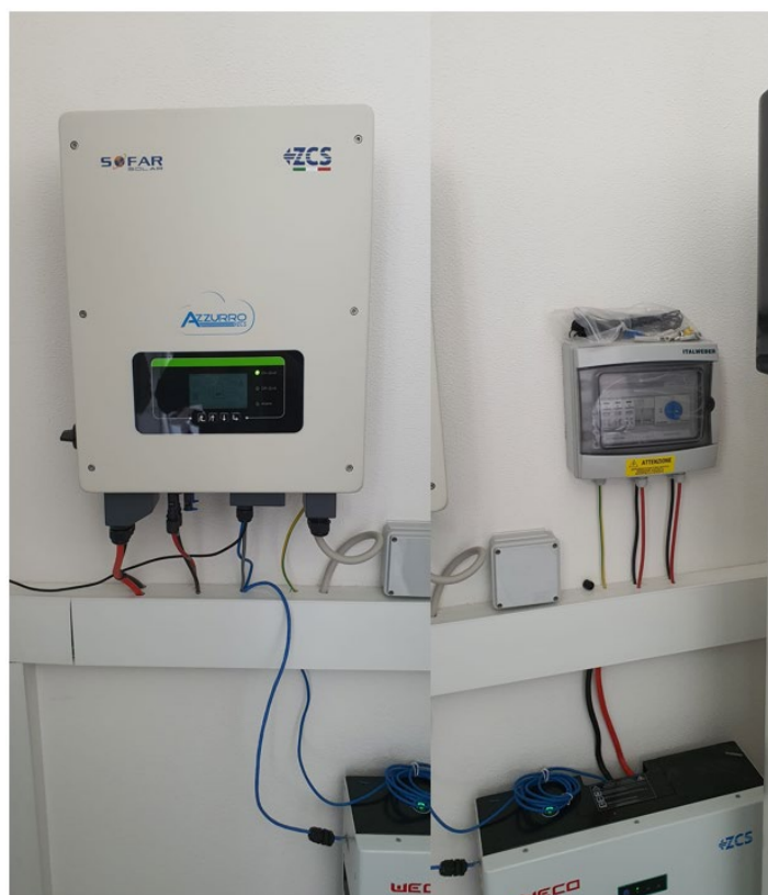
Figura 104: installazione in cabina dell'inverter ibrido da 3 kW, del sistema di accumulo a litio da 4,5 kWh e del quadro di sezionamento stringa
