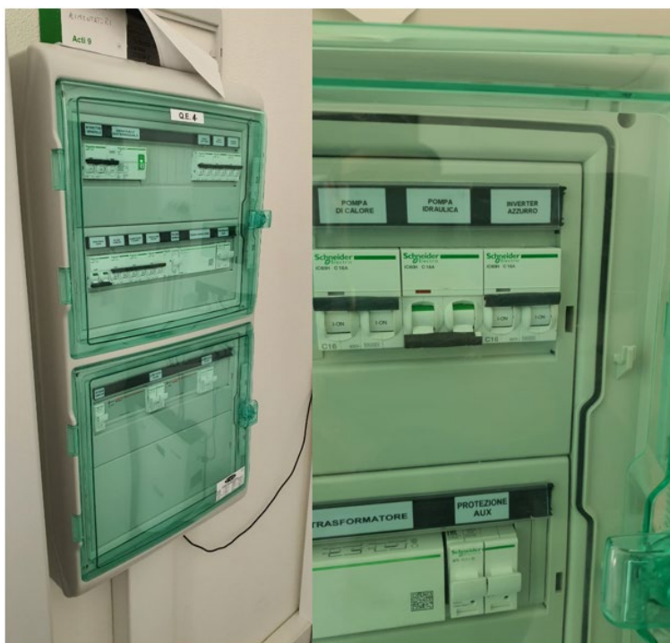
Figura 105: Installazione quadro elettrico generale dell’impianto sperimentale
