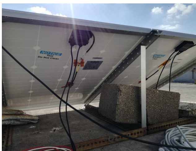
Figura 180: Parte posteriore dei due pannelli installati sul tetto del Dipartimento di Fisica; il pannello di destra viene pulito regolarmente, e fornisce la produzione di riferimento. Il pannello di sinistra non viene pulito e permette di stimare l’effetto del soiling.
