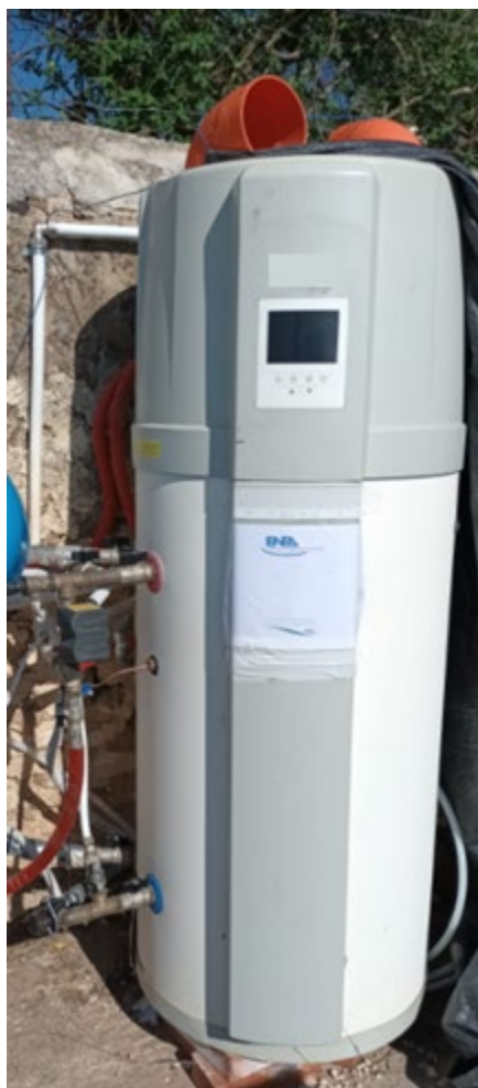
Figura 129: pompa di calore monoblocco per acqua calda sanitaria connessa al cogeneratore dell'impianto sperimentale
