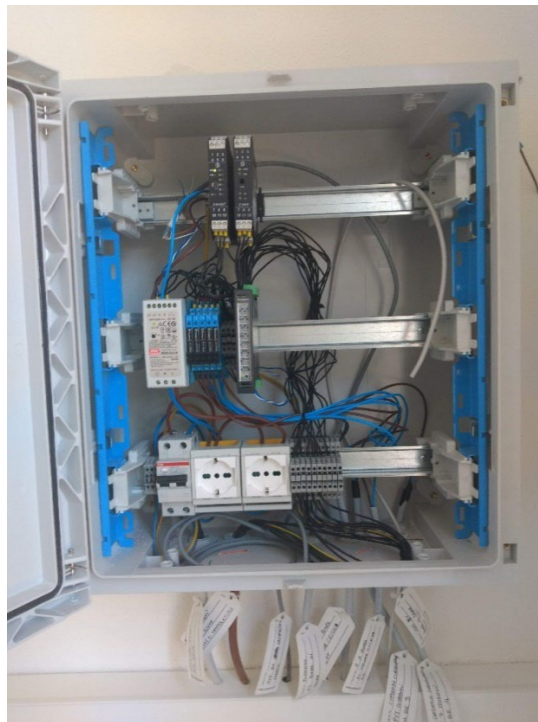
Figura 106: Quadro di comunicazione installato in cabina 3 e contenente i moduli I/O per il controllo dei componenti d'impianto con il PLC.
