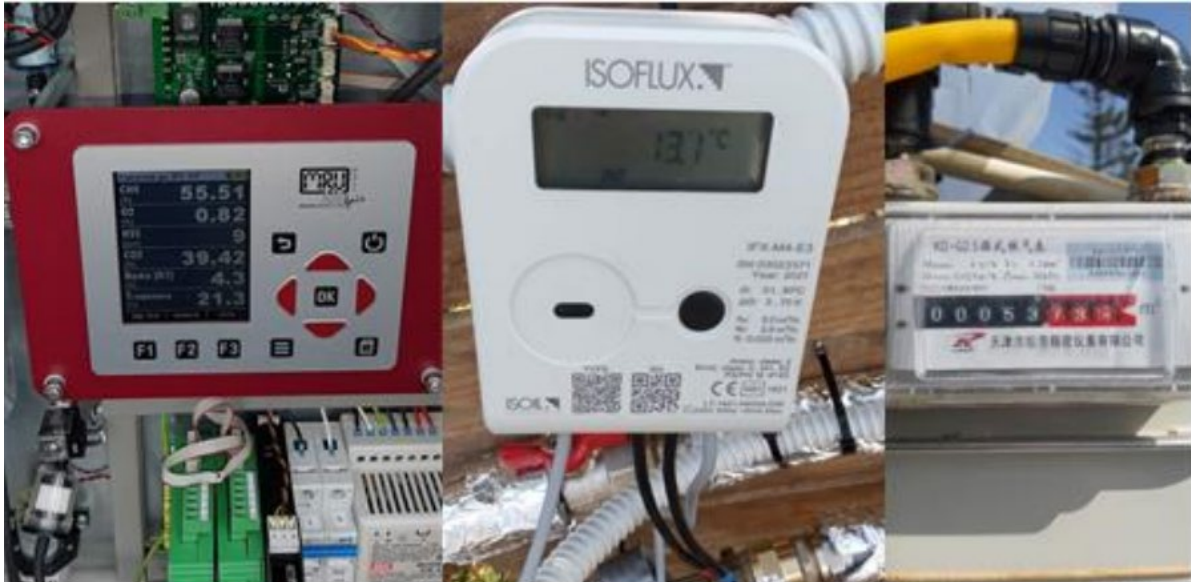
Figura 130: da sinistra: analizzatore di biogas, misuratore energia termica a ultra suoni, misuratore volumetrico biogas
