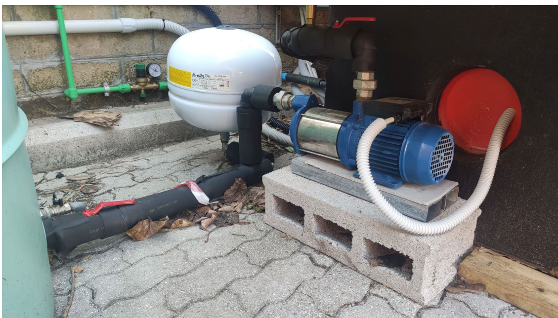
Figura 103: Installazione fuori cabina della pompa idraulica e del vaso di espansione con funzione di autoclave per circuito acqua calda sanitaria
