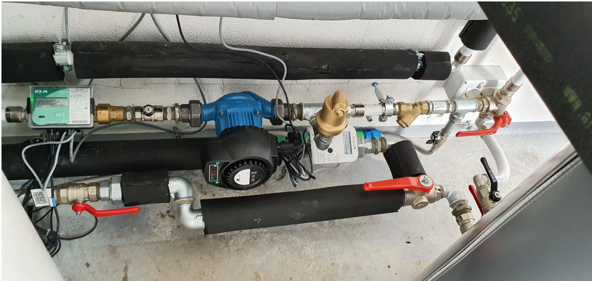
Figura 101: dettaglio installazione componenti per connessione idraulica pompa di calore e accumulo di pre riscaldamento al campo solare fototermico (1)
