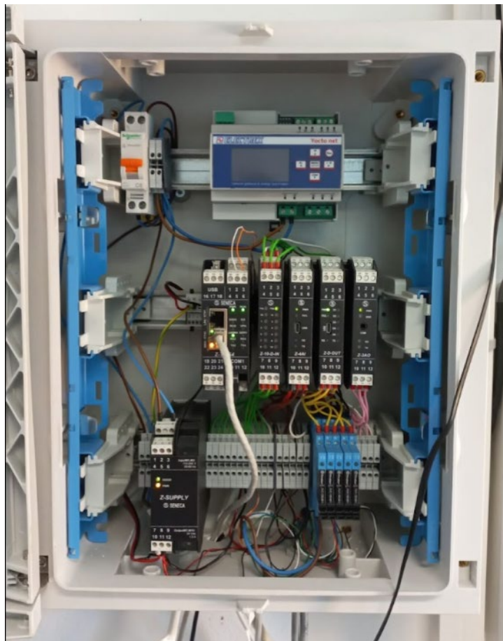
Figura 4: Quadro di automazione e controllo dell'impianto sperimentale con PLC e moduli I/O
