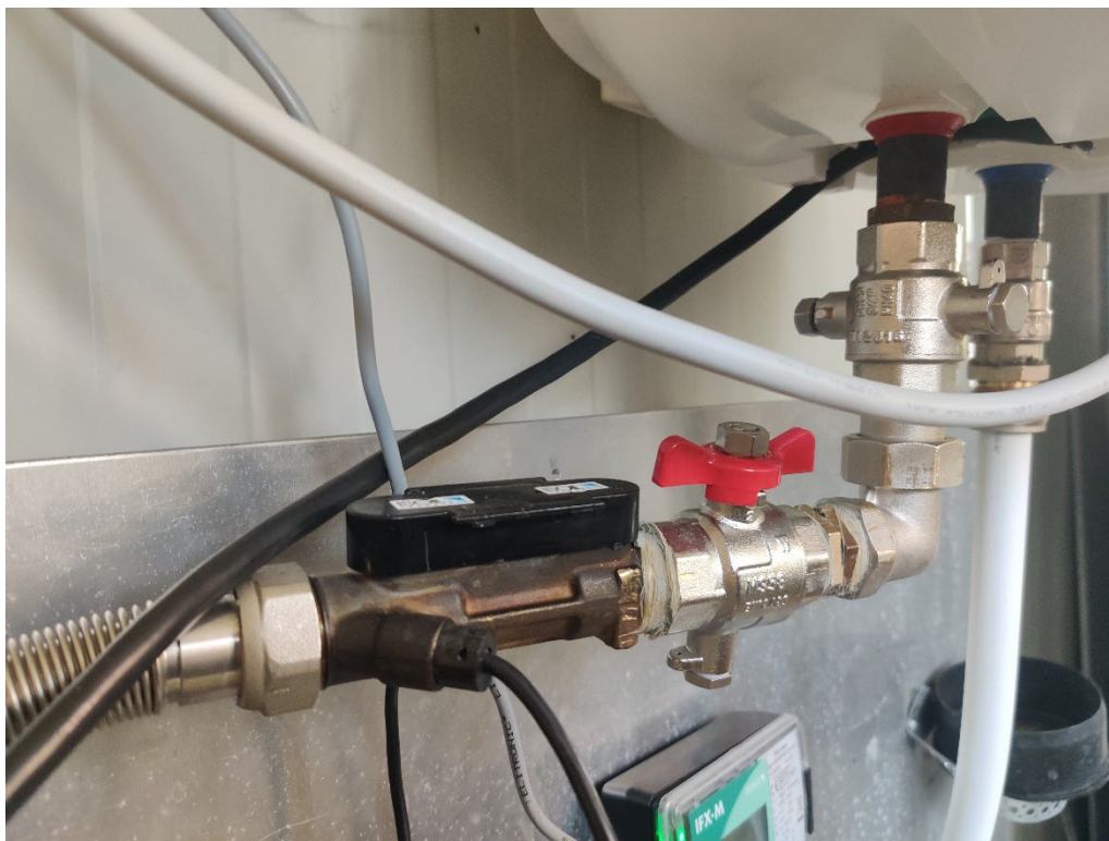
Figura 70: Sistema di test per lo scaldacqua smart. Dettaglio della mandata del boiler e punto di misura
