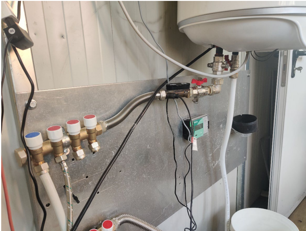
Figura 69: Sistema di test per lo scaldacqua smart. Rappresentazione d'insieme del circuito, lato mandata dello scaldacqua
