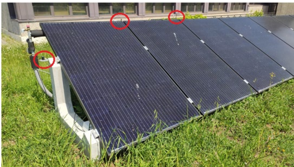
Figura 96: installazione campo foto termico da 2,1 kWp – dettaglio installazione piranometro e sensori di temperatura PT 500
