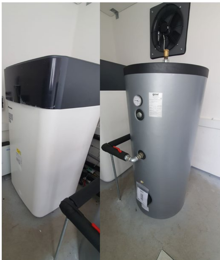
Figura 100: posizionamento in cabina prefabbricata della pompa di calore per ACS da 500 litri e accumulo di pre-riscaldamento
