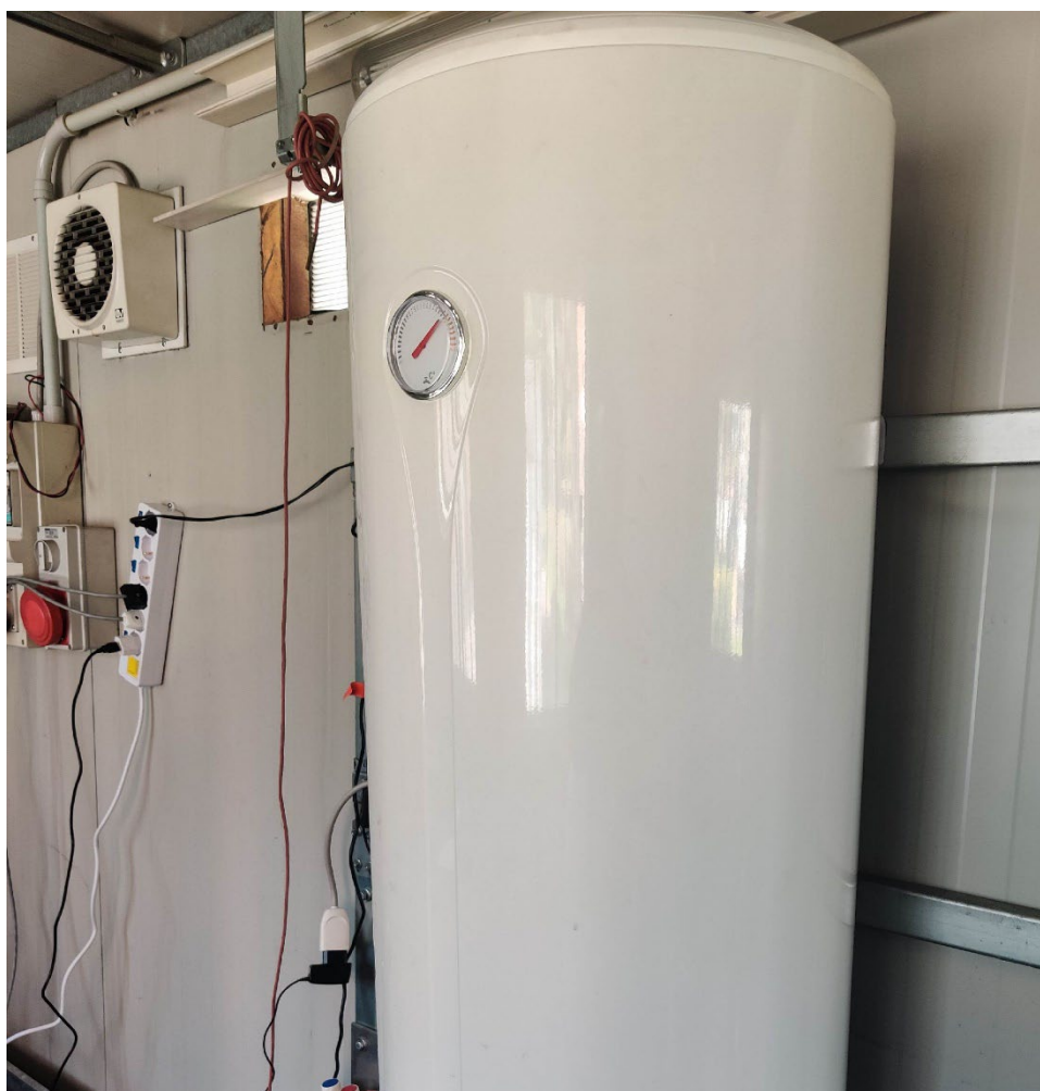
Figura 68: Sistema di test per lo scalda-acqua . Dettaglio dello scalda-acqua
