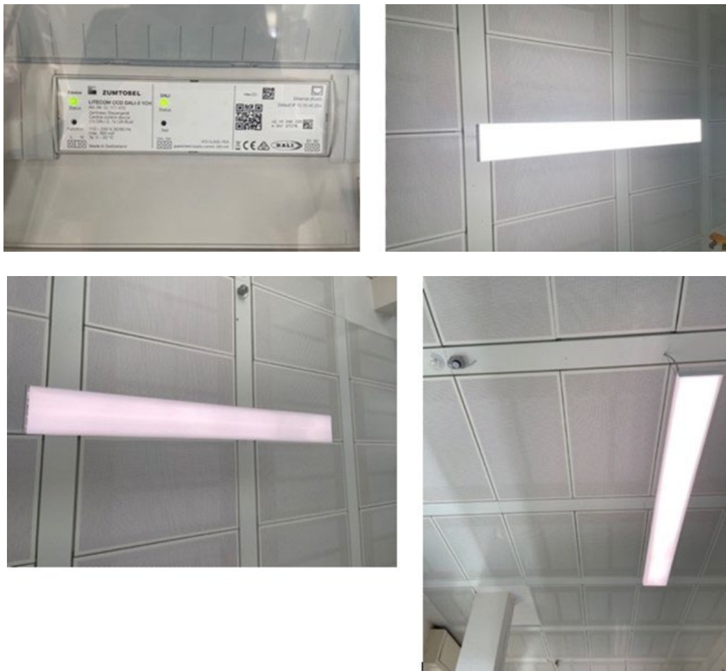
Figura 99. Immagini dei corpi illuminanti installati.
