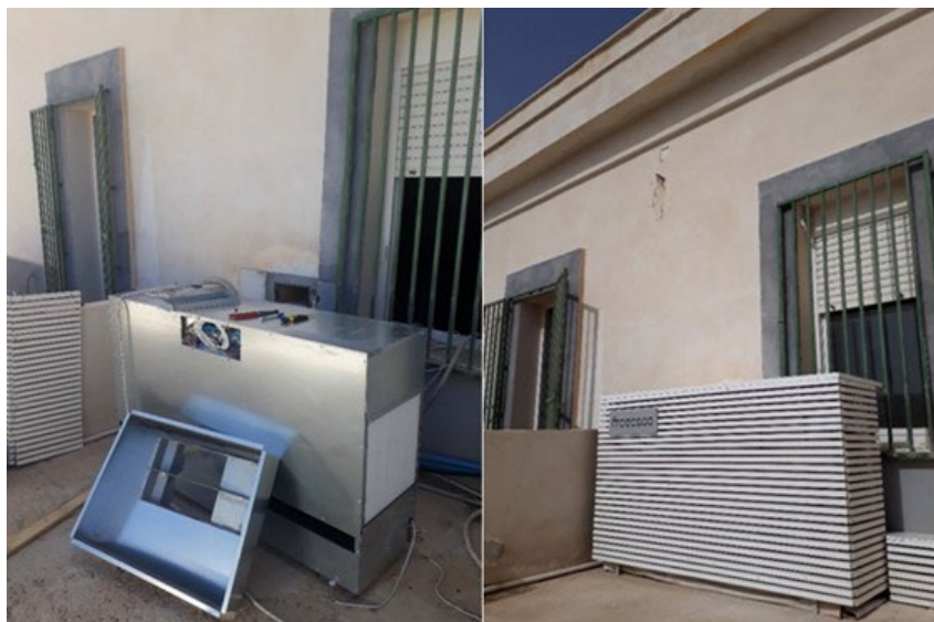
Figura 156. Foto dell'impianto nella configurazione attuale – 05.21.
