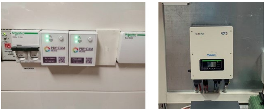
Figura 61. Sistema di monitoraggio del dimostratore: smart meter (sinistra) ed inverter (destra).
