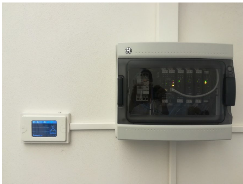
Figura 125. Foto del quadro di monitoraggio con l'unità di acquisizione dati.
