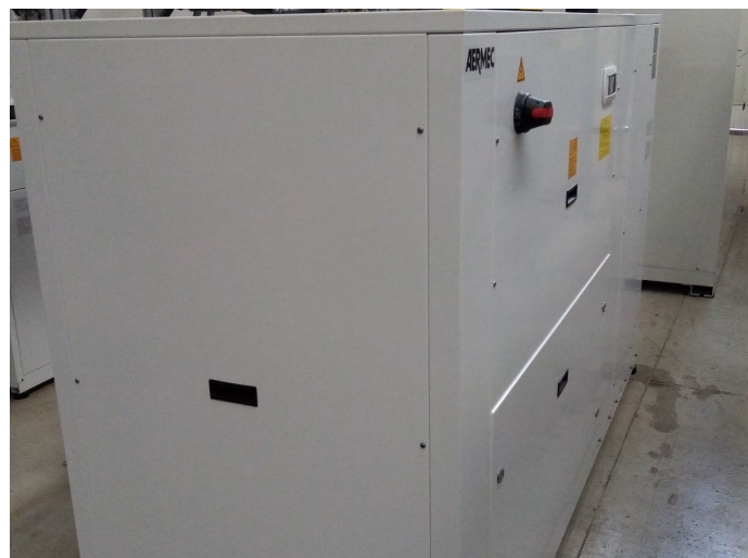
Figura 9. Pompa di calore della rete.
