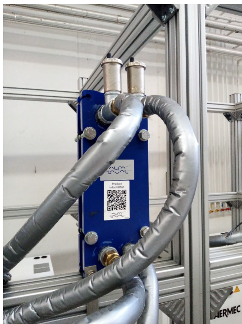
Figura 11. Scambiatore di calore a piastre presente in ciascuna sottostazione di scambio delle pompe di calore delle utenze.
