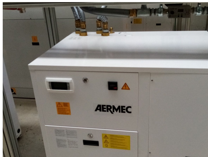
Figura 8. Pompa di calore di ciascun'utenza.
