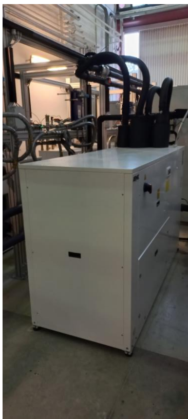
Figura 12. Pompa di calore della rete (AERMEC WRL500).
