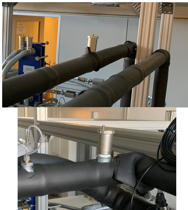
Figura 36. Valvole di sfioro poste nei punti più alti della rete termica.
