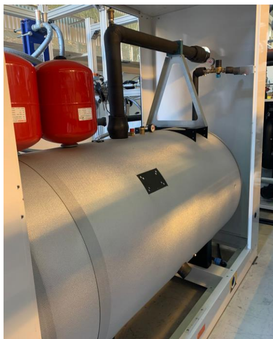
Figura 14. Serbatoio di accumulo da 1000 litri.
