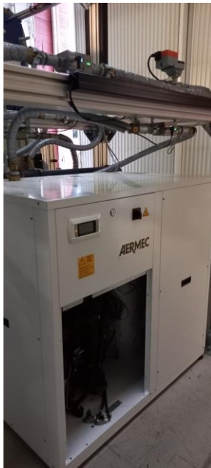
Figura 10. Pompa di calore di ciascun'utenza (AERMEC WRL041).
