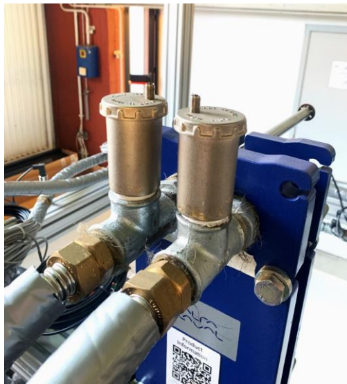
Figura 35. Valvole di sfioro in corrispondenza delle sottostazioni di scambio.
