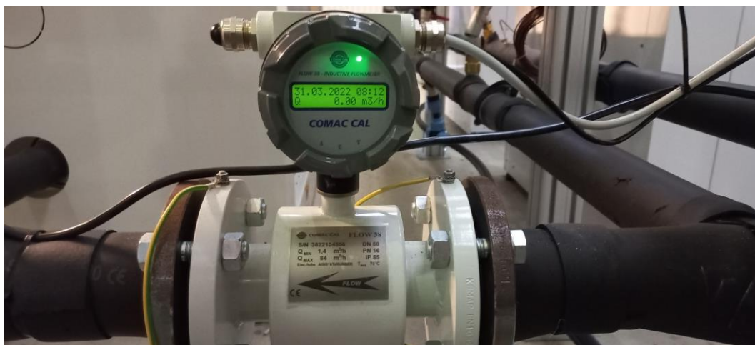
Figura 30. Misuratore di portata elettromagnetico (FLOW 38).
