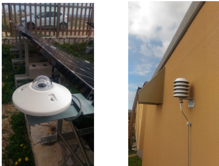
Figura 37. Il sensore di radiazione solare e di temperatura ambiente di nuova installazione
