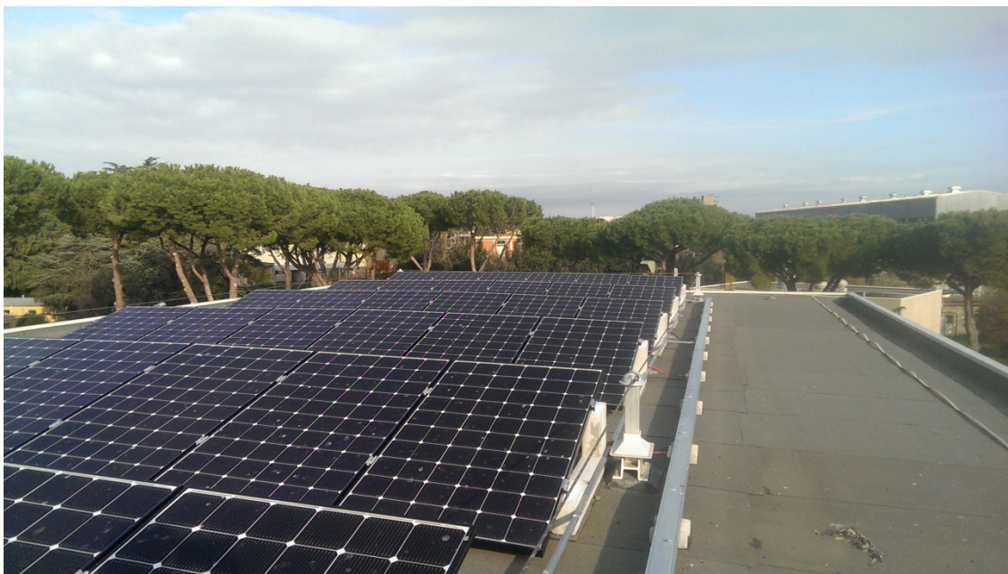
Figura 20. Il Generatore fotovoltaico
