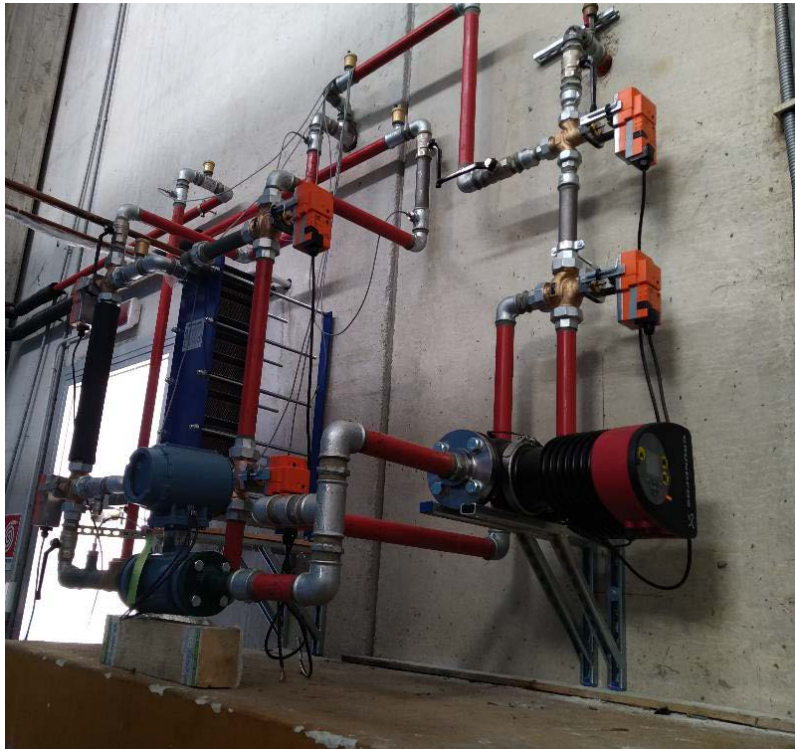
Figura 138 – Primo piano della pompa di circolazione edel misuratore di portata del circuito secondario
