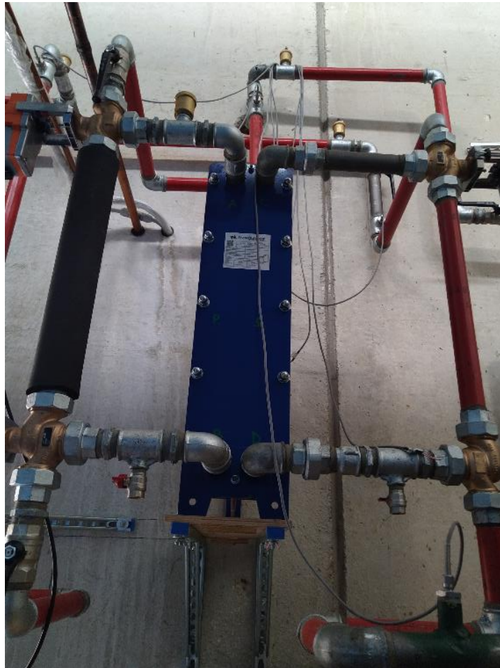
Figura 136 – Scambiatore a piastre installato in campo – vista frontale
