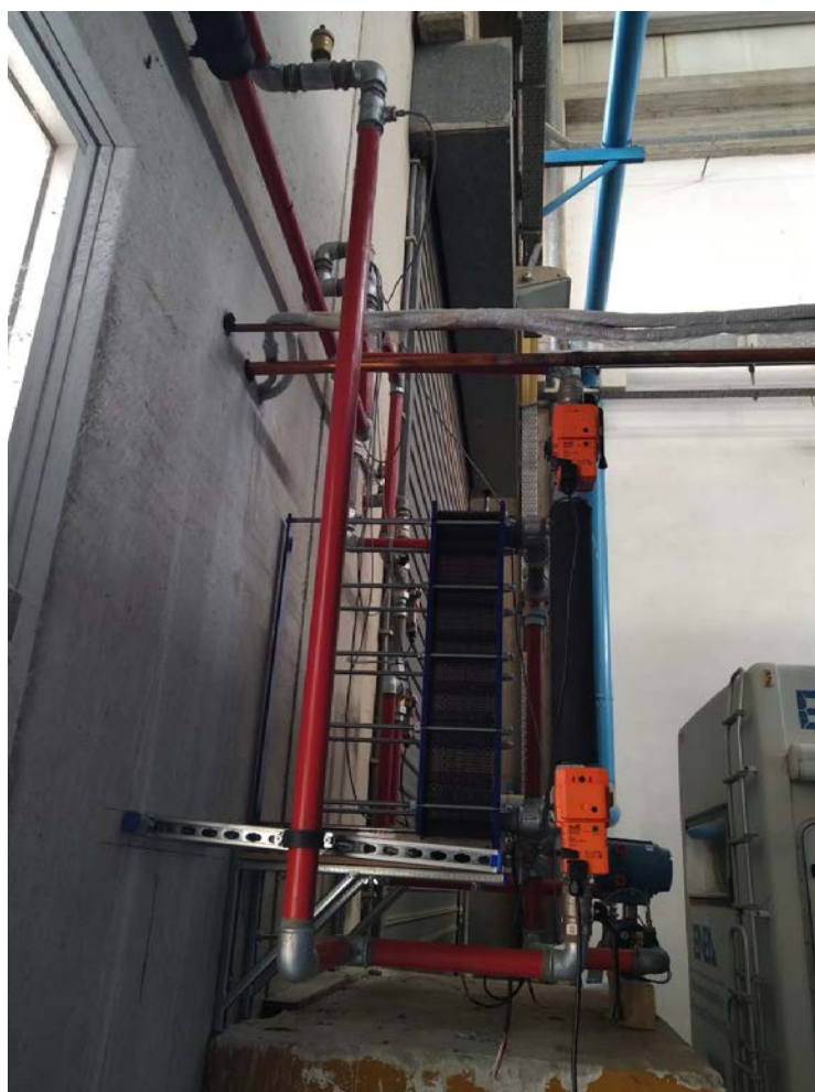
Figura 137 - Scambiatore a piastre installato in campo – vista laterale
