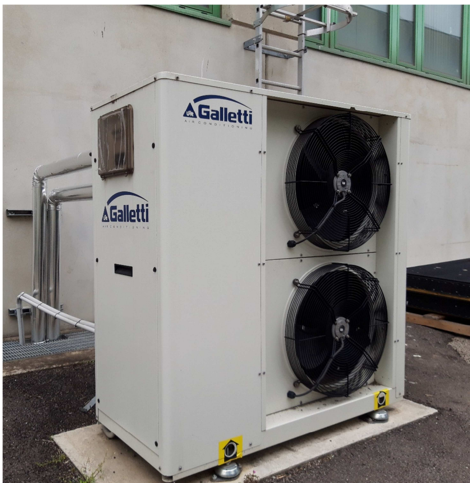
Figura 4. Chiller esterno avente una potenza frigorifera nominale di 18.2 kW.
