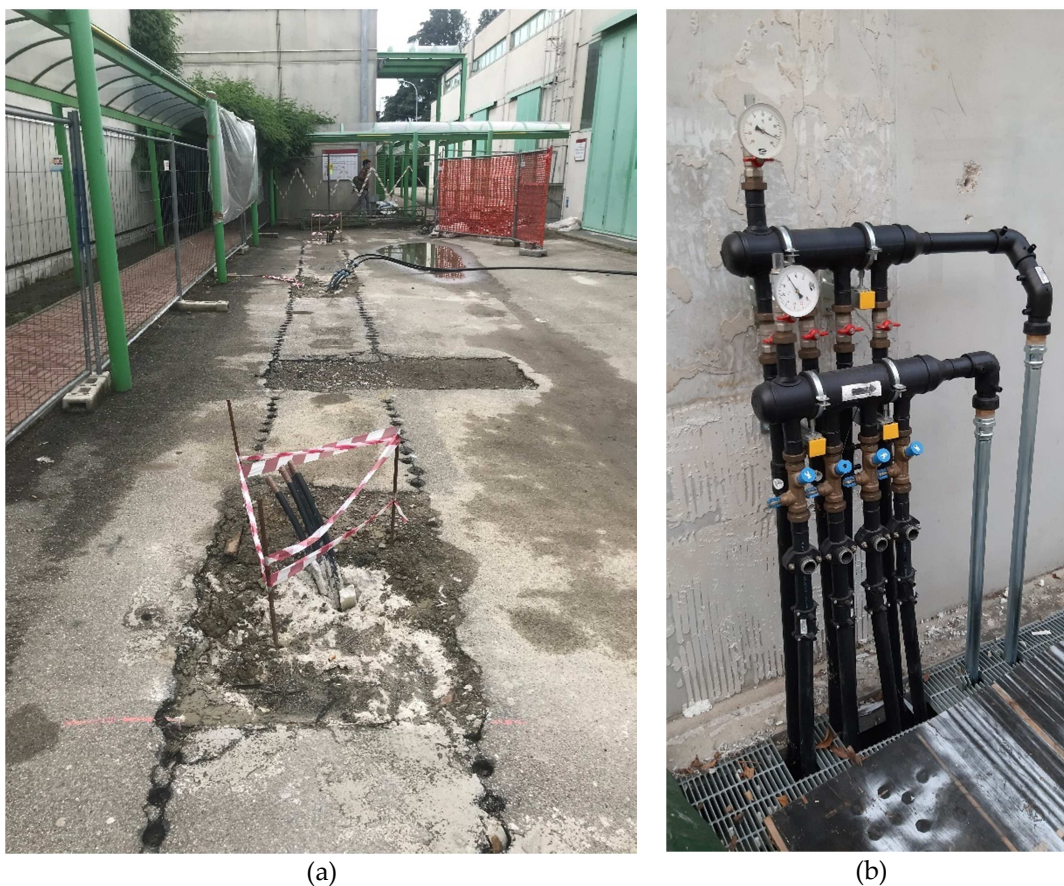
Figura 6. a) Uscita delle sonde geotermiche verticali; b) collettore delle sonde geotermiche.
