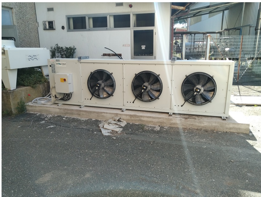
Figura 4 – Condensatore ad aria per il potenziamento del gruppo frigorifero
