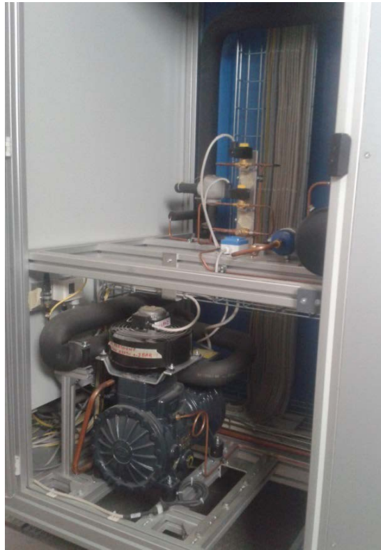
Figura 2 - Gruppo Frigorifero da 21 kW pre-intervento di potenziamento
