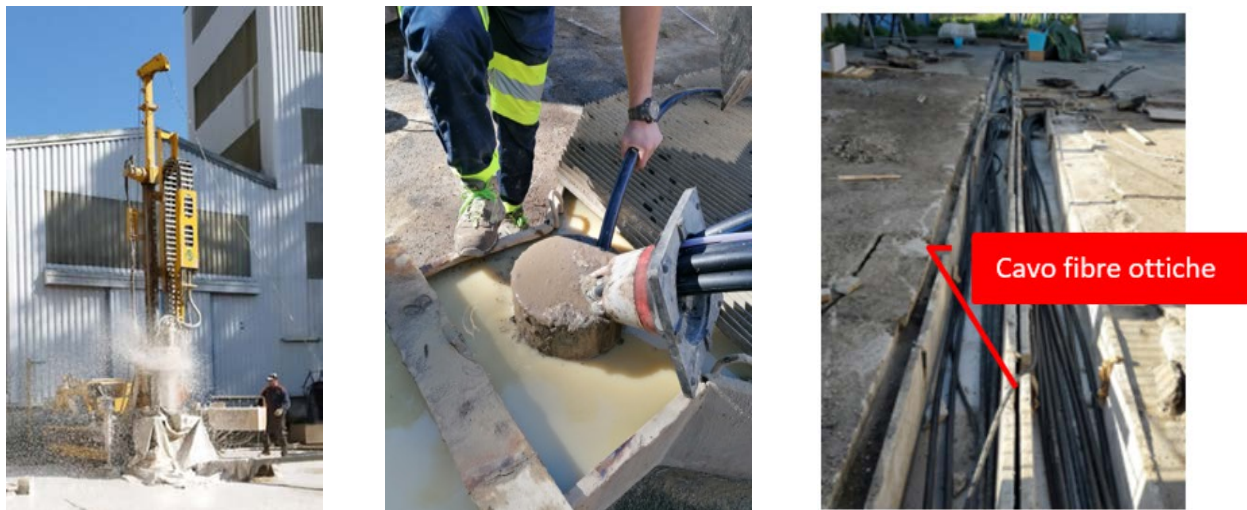
Fasi di realizzazione e strumentazione del campo geotermico presso il C.R. ENEA Casaccia
