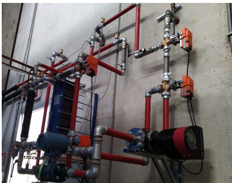
Componentistica installata sull'HiL per l'interfaccia tra impianto reale e emulatore fisico dell'utenza
