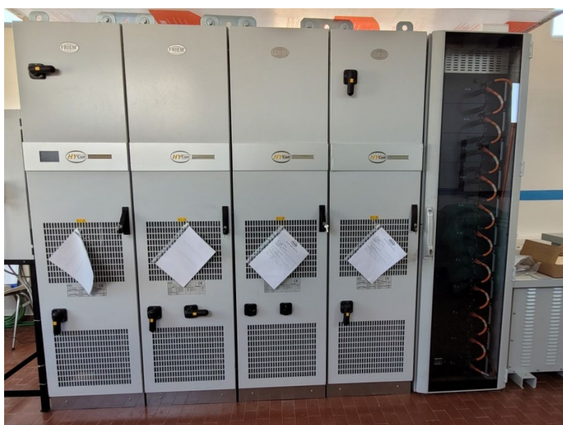
Figura 23. Sistema di accumulo FAAM e Gruppo di conversione FRIEM SmartRange 50.40PV.
