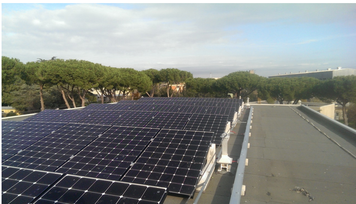
Figura 1. Generatore fotovoltaico installato sulla copertura dell'edificio F40.
