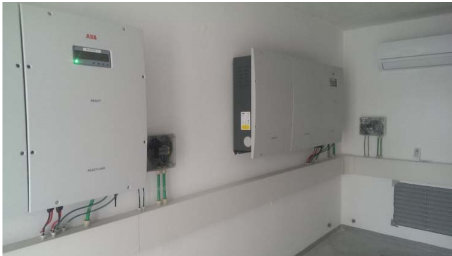
Figura 2. L'inverter fotovoltaico e il sistema di accumulo ABB REACT.
