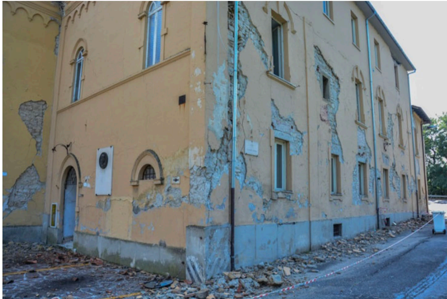
Figura 73: Ospedale di Amatrice: danneggiamento dell'edificio in muratura [20]
