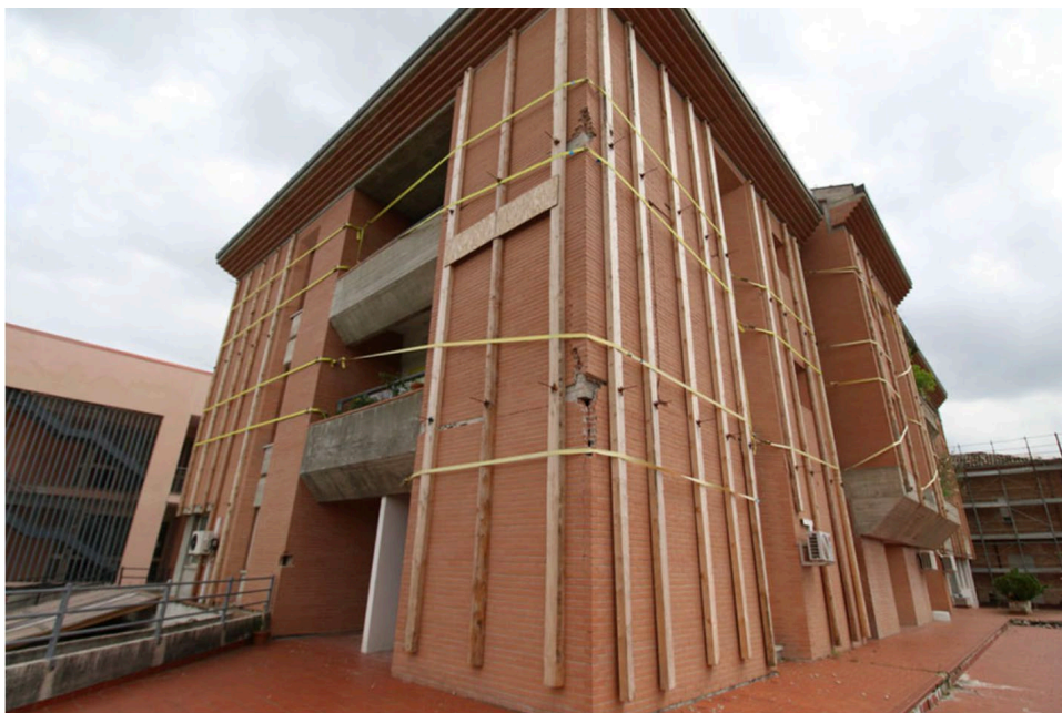
Figura 74: Ospedale di Amendola: separazione del rivestimento esterno in laterizio e dei supporti provvisori [25]
