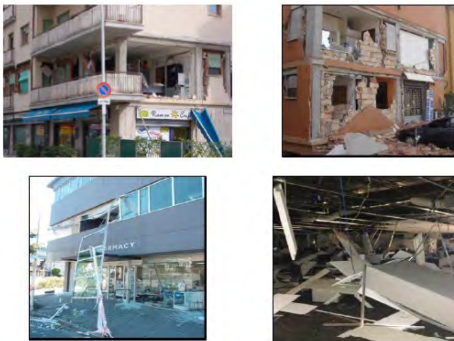
Figura 66. Esempio di danneggiamento di elementi non-strutturali (facciate, partizioni, controsoffitti) a seguito dei terremoti di L’Aquila 2009 e Christchurch 2011 (Nuova Zelanda) (Christchurch: Baird et al. [46], Dhakal et al. 2016 [47]; L’Aquila: De Sortis et al. [48])
