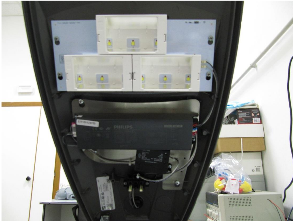
Figura 22 – Interno della lampada: sono visibili i tre gruppi LED ed i regolatori di potenza
