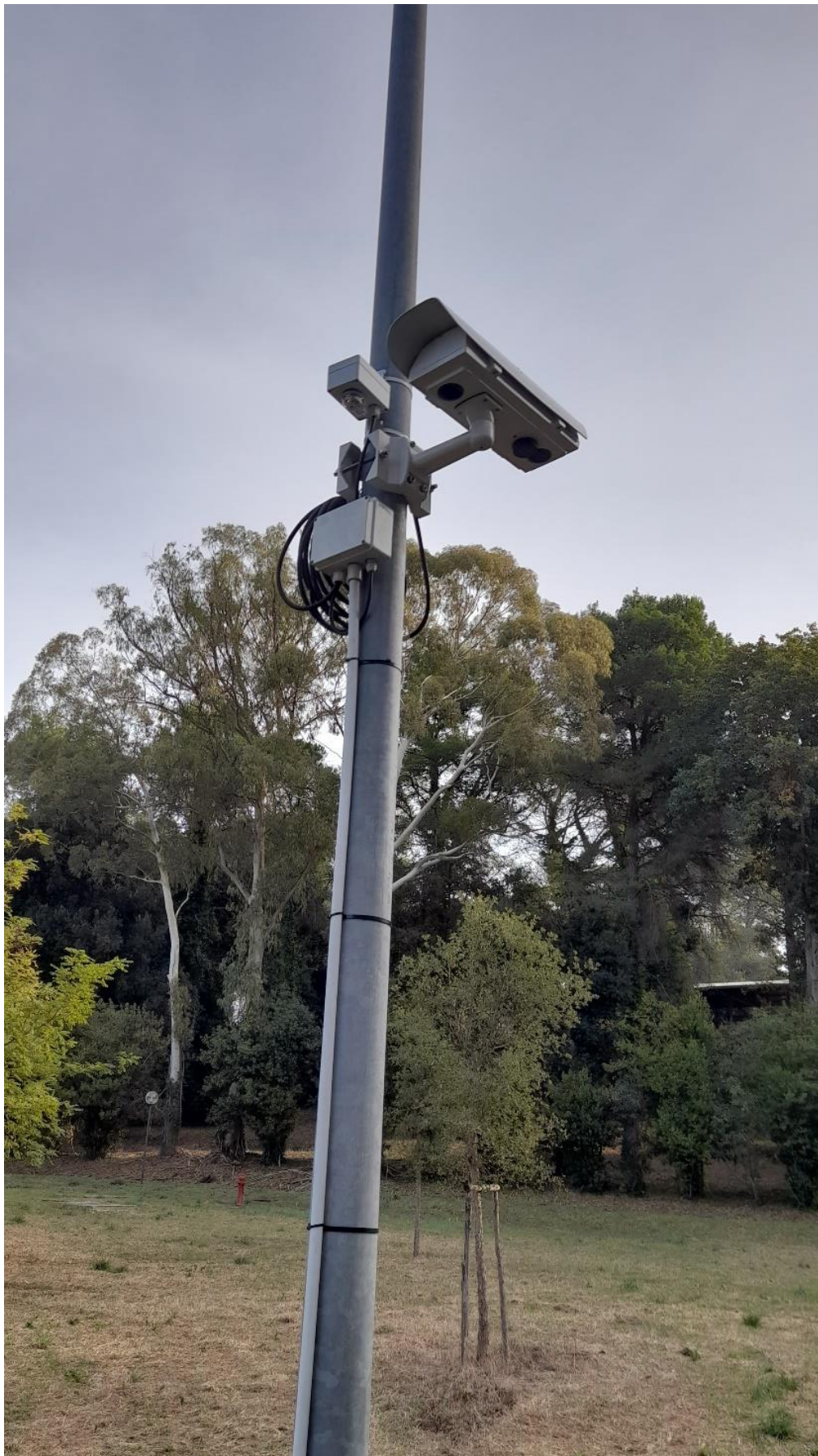
Figura 19 – vista esterna di telecamera e sensori installata presso il CR ENEA La Casaccia.
