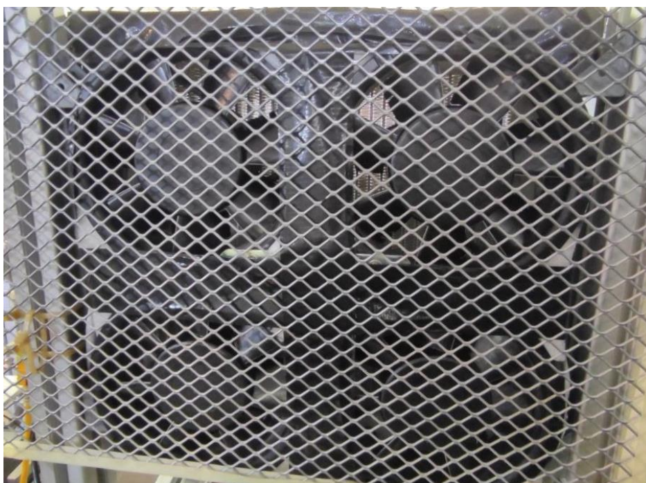
Figura 27. Ventole di raffreddamento del condensatore
