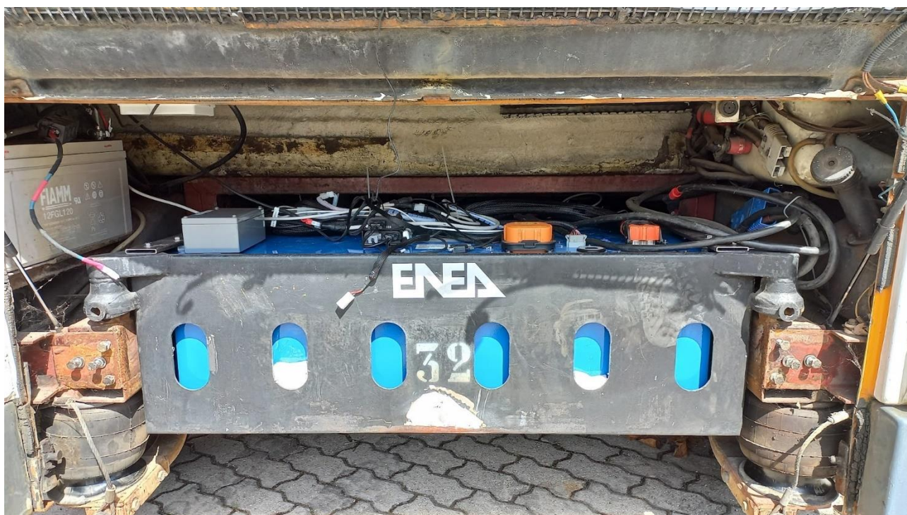
Figura 3: Batteria da 16.3 kWh installata in uno dei due cassoni del Tecnobus Gulliver
