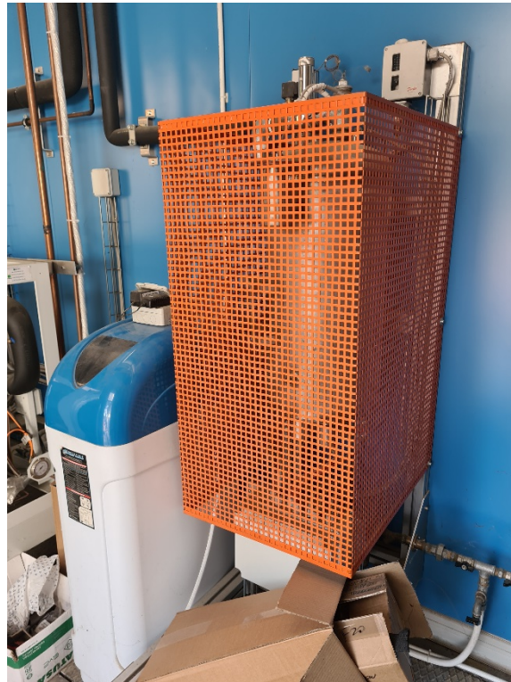
Figura 6: Generatore di vapore e addolcitore d'acqua.
