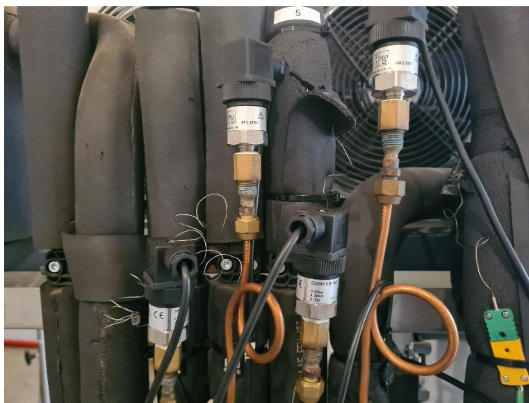
Figura 22: Esempio installazione termocoppie e sensori di pressione
