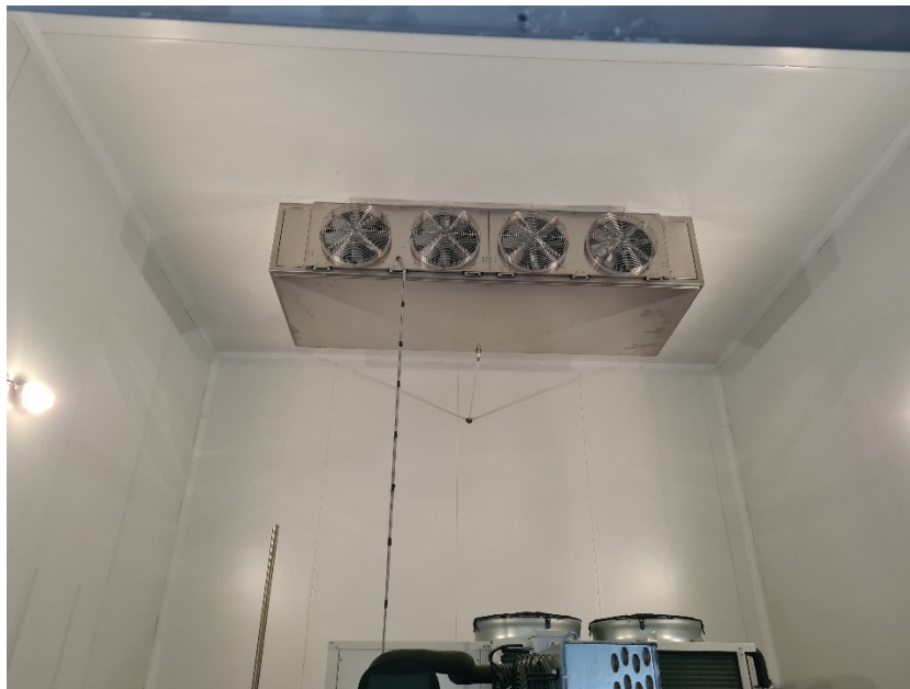
Figura 3: Unità di condizionamento interna alla camera climatica.
