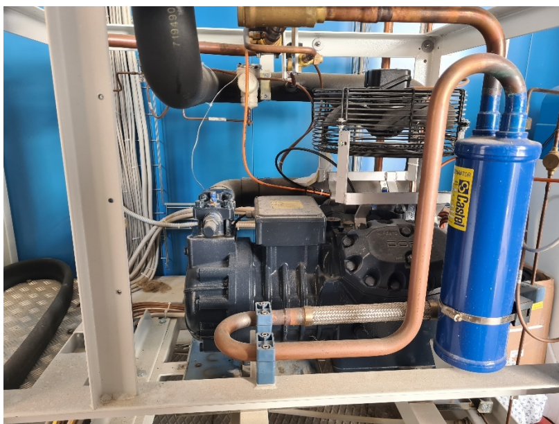
Figura 5: Sistema frigorifero Calorimetro Enea.
