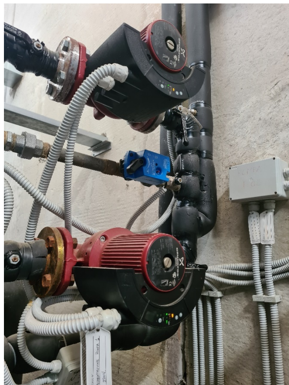
Figura 10: Pompa di circolazione Grundfos.
