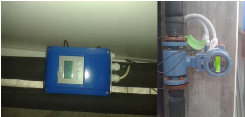
Figura 23: Misuratori di portata installati sull’impianto Calorimetro ENEA, modello Krohne Optiflux 5000 a sinistra e Rosemount 8732E a destra
