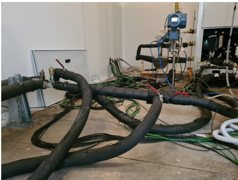
Figura 14: Derivazione tubazioni per alimentazione delle pompe di calore a basso GWP.
