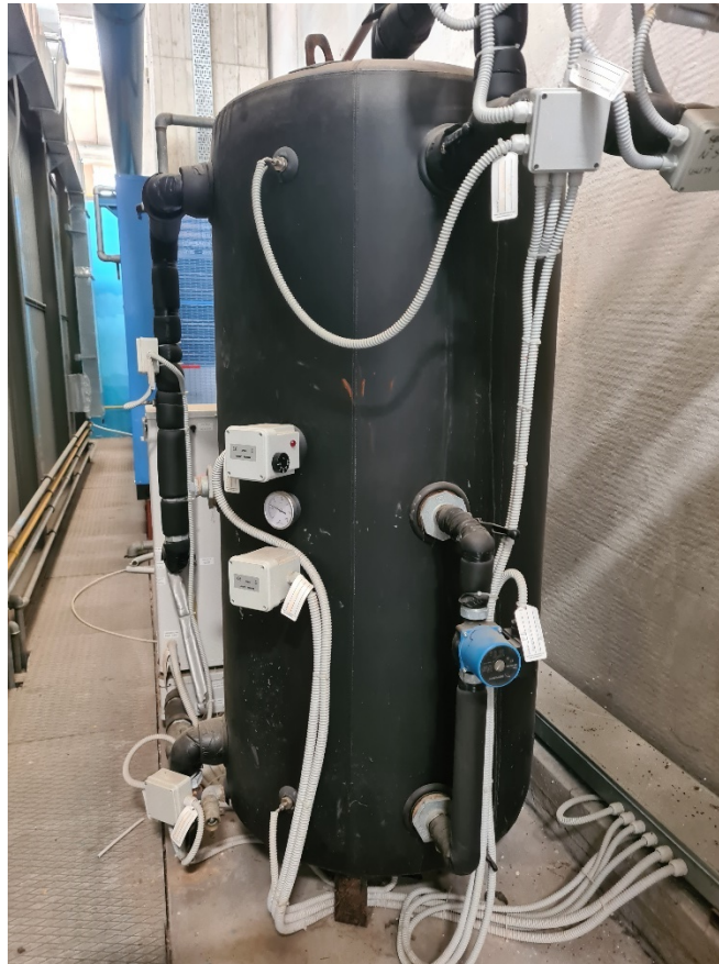
Figura 8: Serbatoio d'accumulo con resistenze elettriche.
