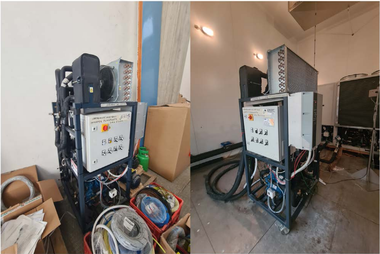
Figura 16: Nuovi prototipi delle pompe di calore (destra R1234ze), visibile il nuovo compressore e inverter.
