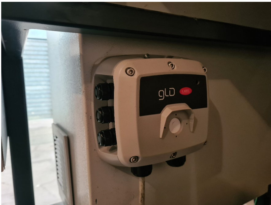
Figura 28: Sensore GLD Carell posizionati sul retro del quadro di una delle pompe di calore in prova
