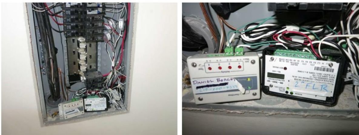
Figura 10. Dettaglio dell'installazione del sistema di monitoraggio dei consumi elettrici delle pompe di calore del caso di studio [3].
