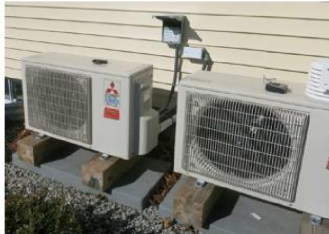
Figura 8. Dettaglio dell'installazione delle unità esterne delle pompe di calore, utilizzate per la climatizzazione invernale del caso di studio [3].
