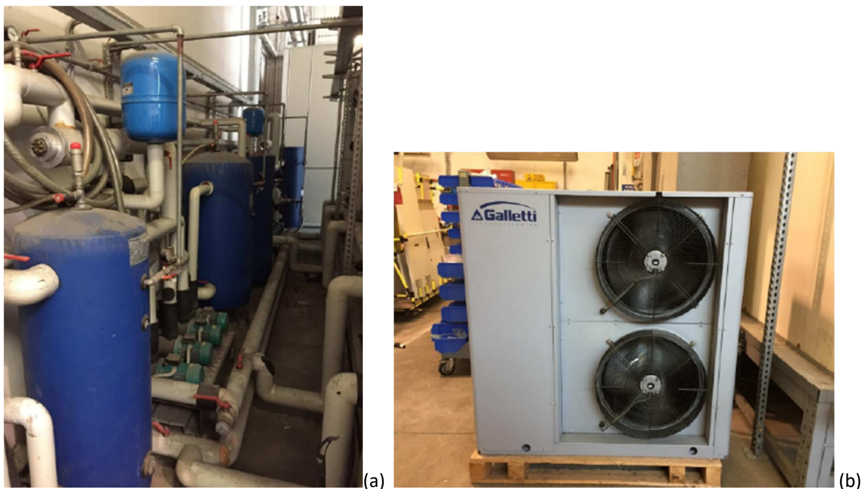
Figura 7. Impianto di condizionamento del calorimetro (a) e chiller al servizio dello stesso (b)
