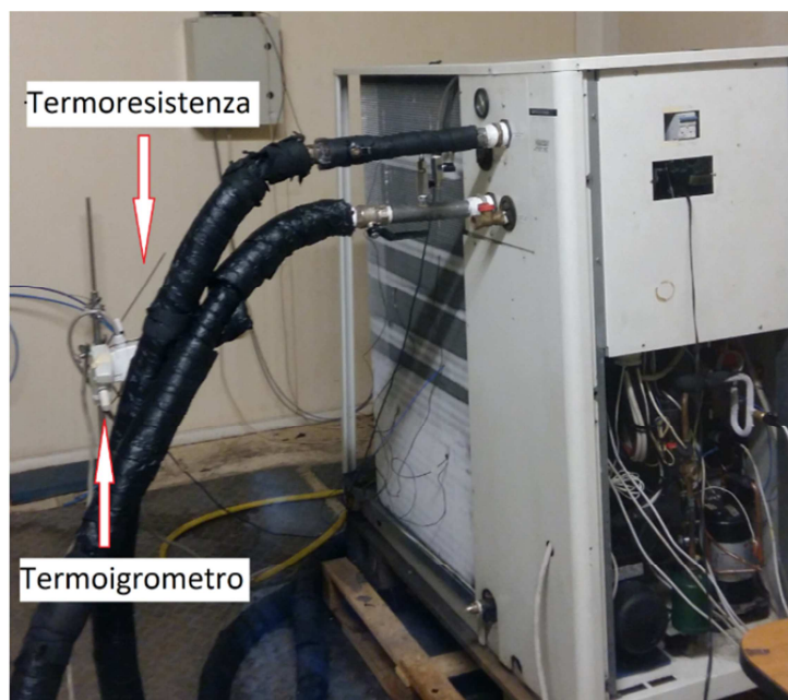
Figura 9. Termoresistenza e termoigrometro per la misura delle condizioni ambientali dell'aria all'interno della cella frigorifera
