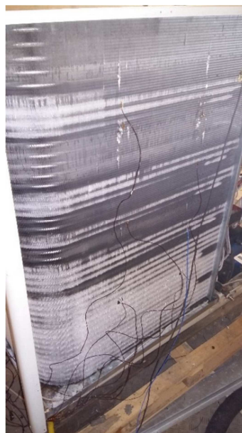
Figura 17. Batteria alettata ricoperta di brina durante un test condotto all'interno della frosting region
