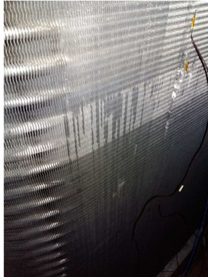
Figura 15. Batteria alettata durante una prova per la ricerca della condensing line. Si evidenzia la formazione di condensa
