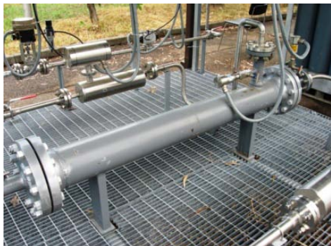
Cartridge di contenimento del modulo a membrane
