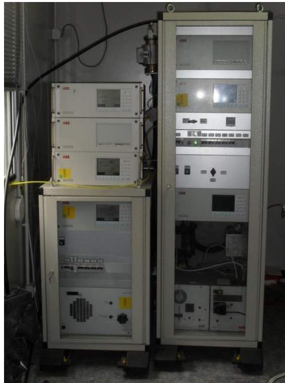
Figura 8. Analizzatori in continuo ABB
