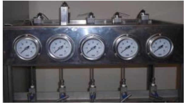
Figura 26. Manometro gas inlet
