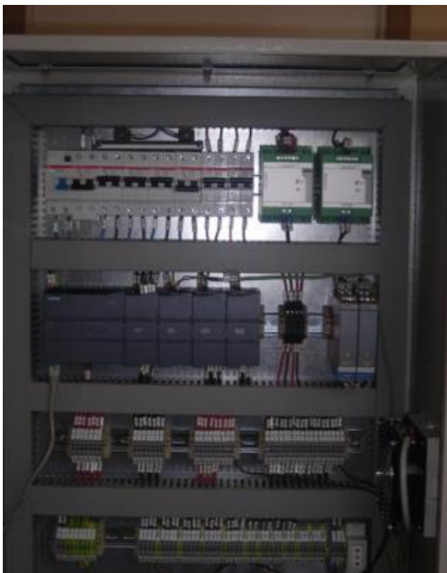
Figura 30. Quadro di Controllo
