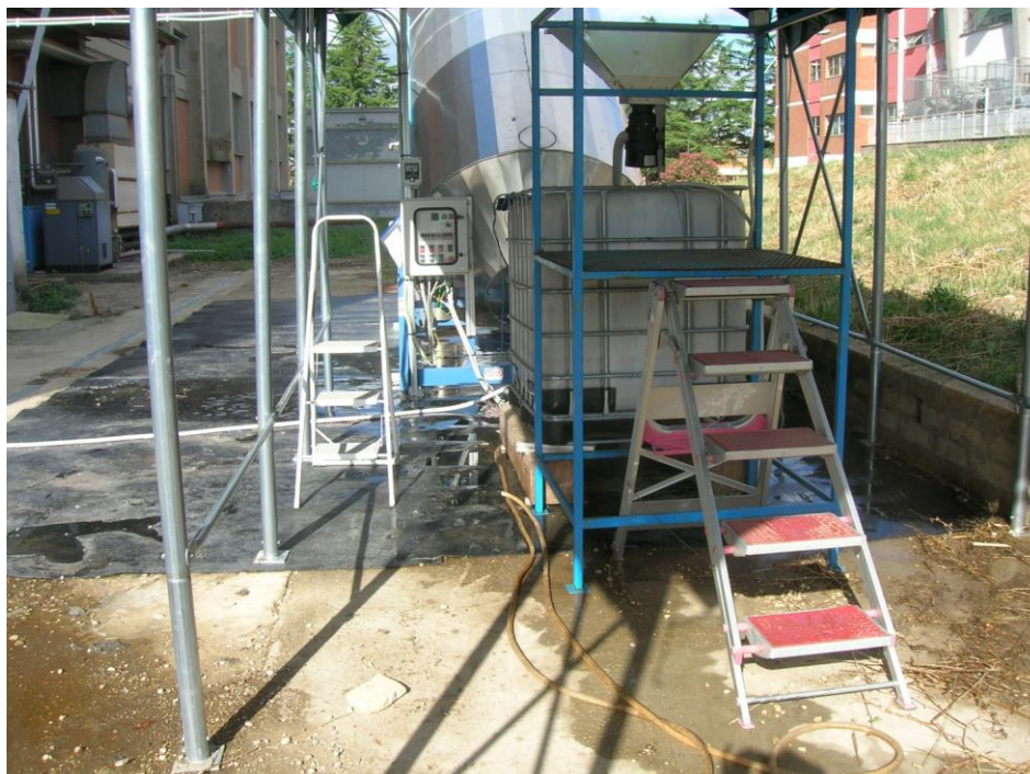
Figura 5. Sistema di carico, trituratore e serbatoio di alimentazione
