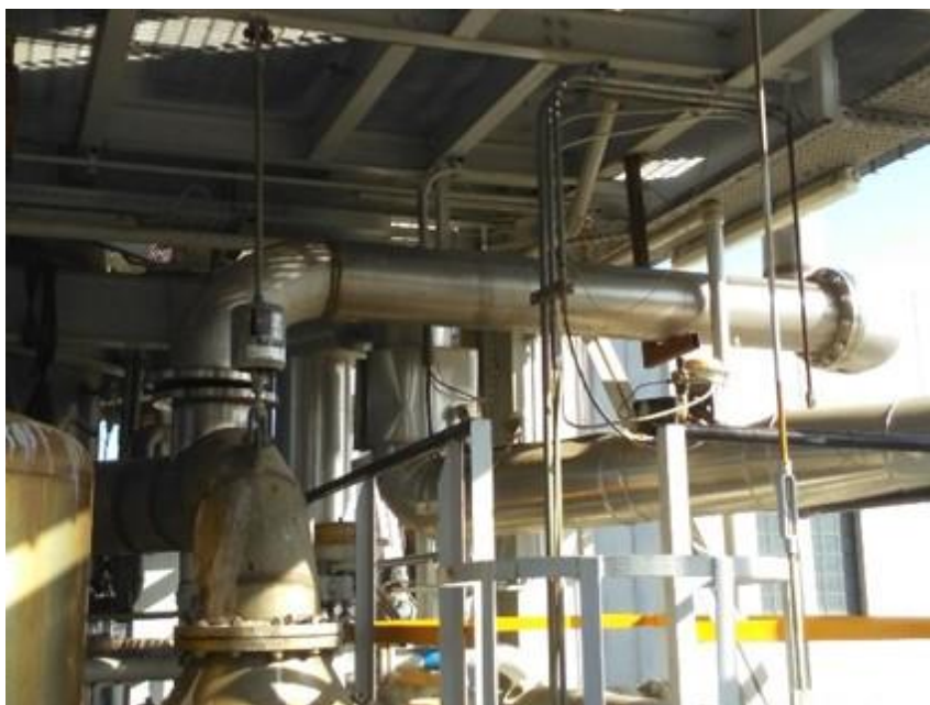
Figura 2.21. Particolare del punto di intercettazione del nuovo vent all'uscita dello scrubber
