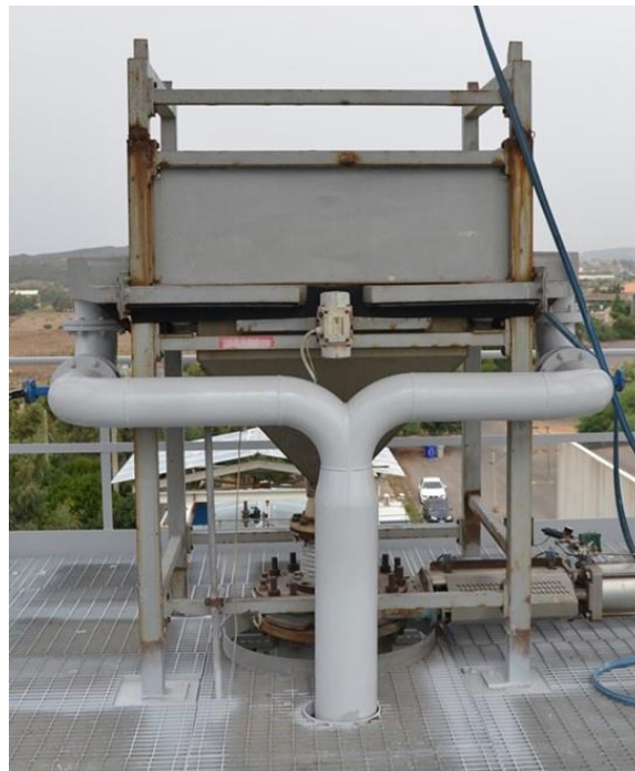
Figura 2.1. Tramoggia del sistema di caricamento del gassificatore
