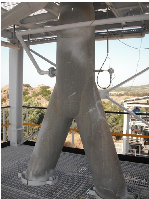
Figura 2.2. Tubazioni del sistema a Y per il caricamento del combustibile nel gassificatore
