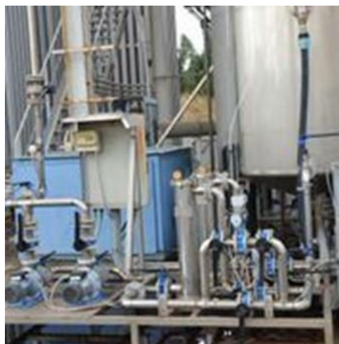
Figura 2.20. Vasca di accumulo e sistema di ricircolo acqua di lavaggio
