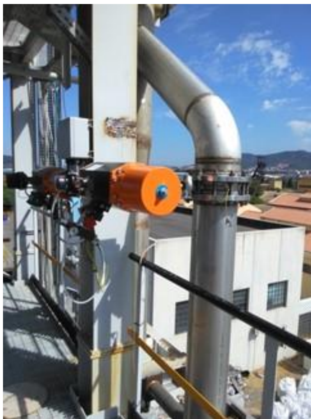
Figura 2.22. Valvola a farfalla con attuatore pneumatico su vent scrubber
