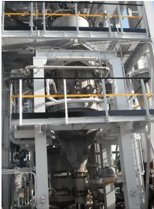
Figura 2.1. Gassificatore impianto dimostrativo (parte inferiore)
