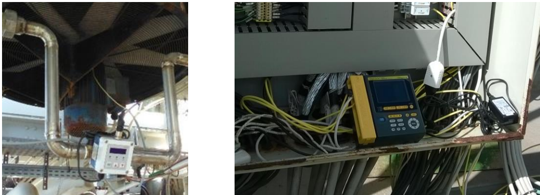
Figura 5.2. Misuratore di portata condensa ad ultrasuoni e datalogger di acquisizione
