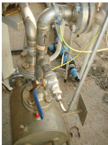
Fig. 9 – Presa di campionamento inserita nei punti di passaggio del gas dell’impianto pilota
