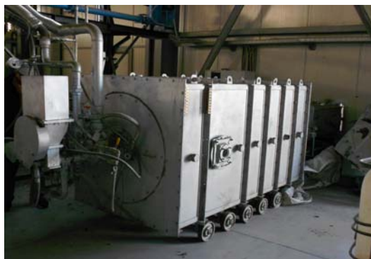
Figura 2.4. Camera di combustione
