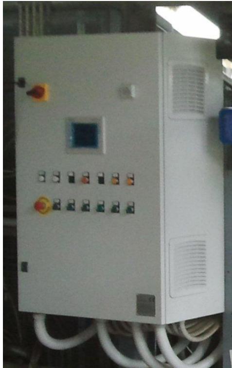
Figura 8: Il quadro elettrico di controllo.
