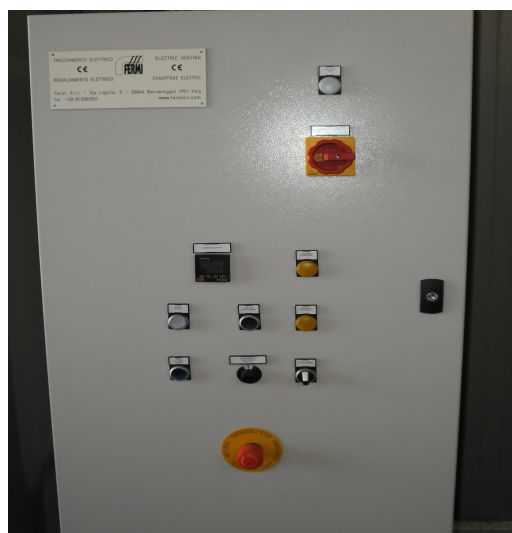
Figura 2.2.2 .quadro di regolazione e controllo surriscaldatore elettrico
