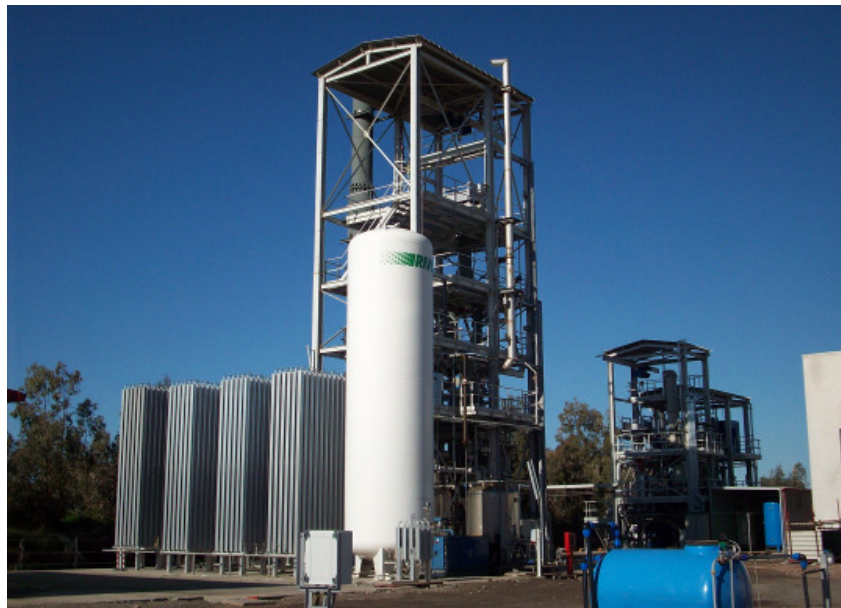
Figura 1.1 . La piattaforma pilota Sotacarbo.
