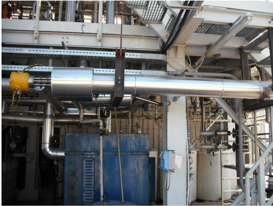
Figura 2.8.2 . coibentazione del riscaldatore degli agenti gassificanti
