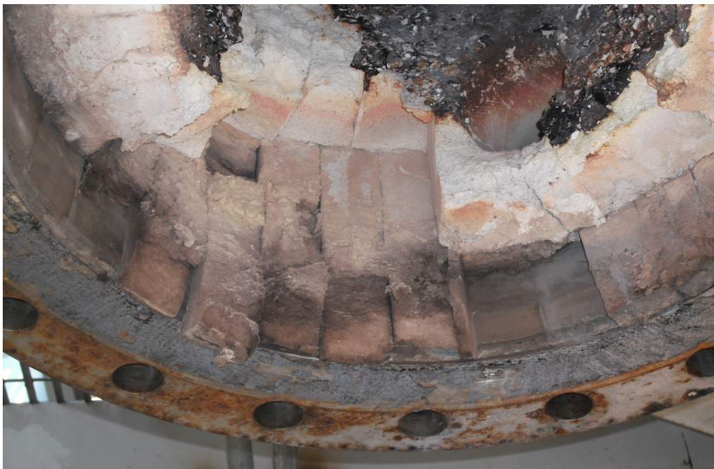
Figura 2.3.3 .refrattario lesionato da sostituire
