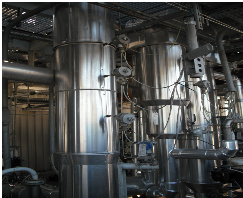
Figura 2.8.1 . coibentazione reattori di CO-Shift
