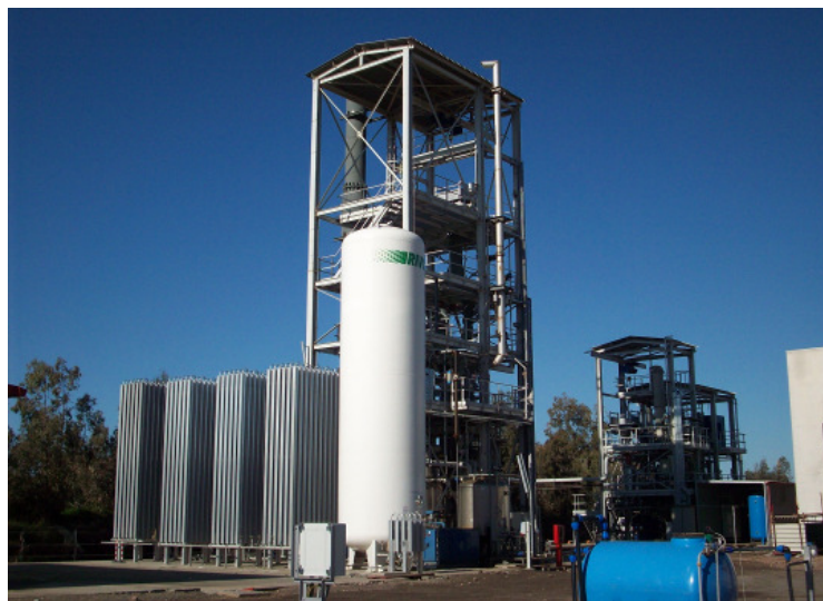
Figura 1.1. La piattaforma pilota Sotacarbo.
