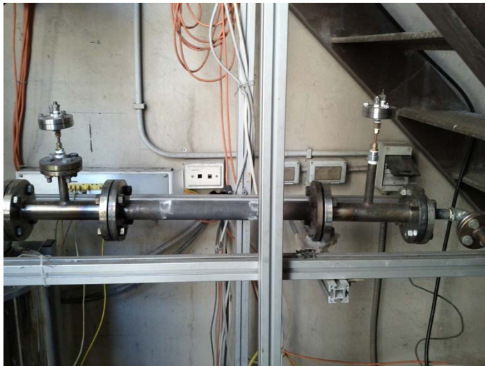
Fig. 1: Particolare del secondo stadio con i sistemi di prelievo campioni.
