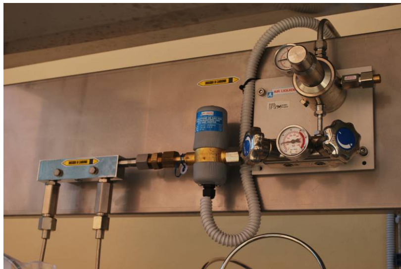
Figura 2.3. Particolare del riscaldatore elettrico e del sistema di riduzione della pressione.
