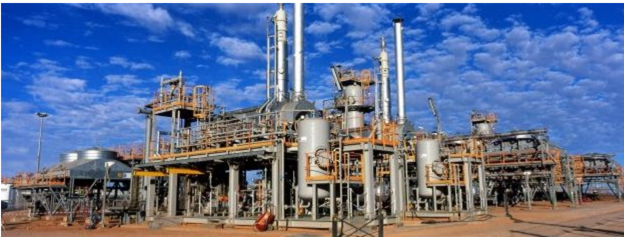
Figura 8.11. L'impianto di In Salah in Algeria 90 .
